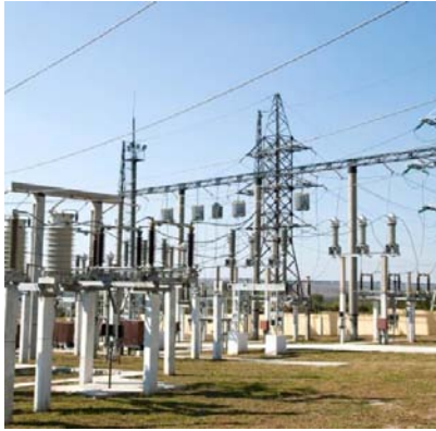
Figura 2.4 Subestación eléctrica de maniobra [7].
