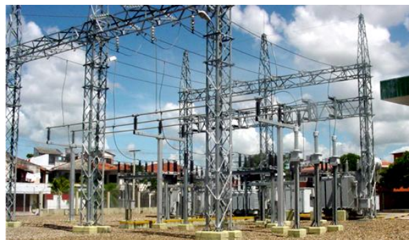
Figura 2.3 Subestación eléctrica reductora [6].
