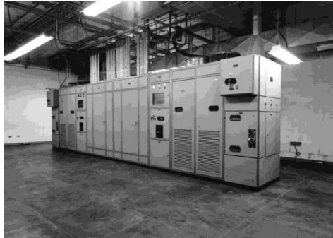
Figura 2.6 Subestación eléctrica tipo interior [9].
