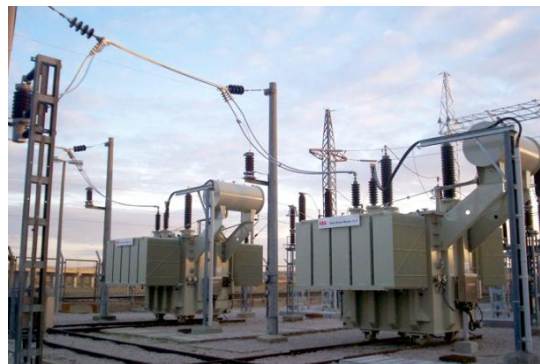
Figura 2.5 Subestación eléctrica tipo intemperie [8].
