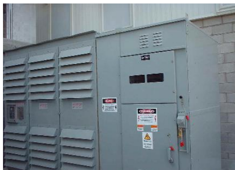
Figura 2.7 Subestación eléctrica tipo blindado [10].
