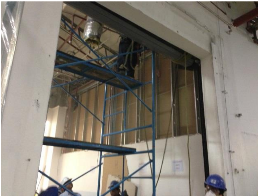
FIGURA 1.15 Imágenes del área a remodelar. Retiro de muro Memoria fotográfica del proyecto "Chichen Itza"
