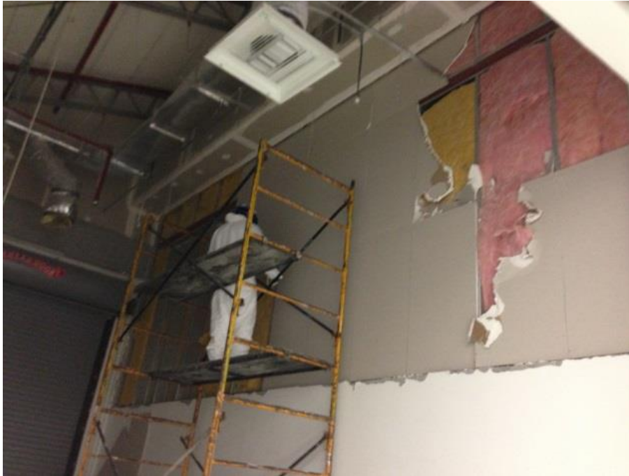
FIGURA 1.14 Imágenes del área a remodelar. Retiro de muro Memoria fotográfica del proyecto "Chichen Itza"
