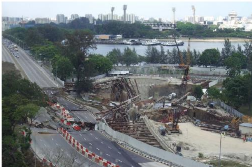
Figura 1.21 Colapso del muro de retención de la estación Nicoll Highway en Singapur, marzo de 2004.
