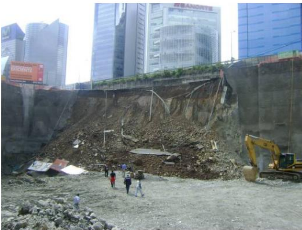
Figura 1.23 Vistas exterior e interior del deslizamiento.
