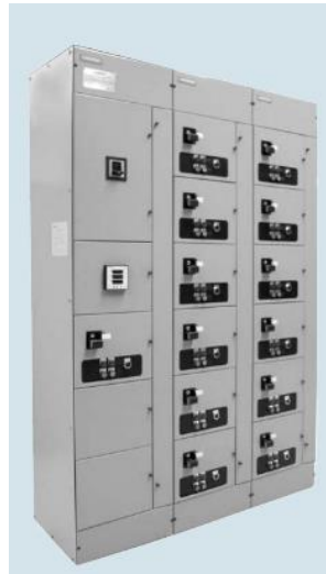
Fig. 14. Centro de control de motores acoplado a la subestación
