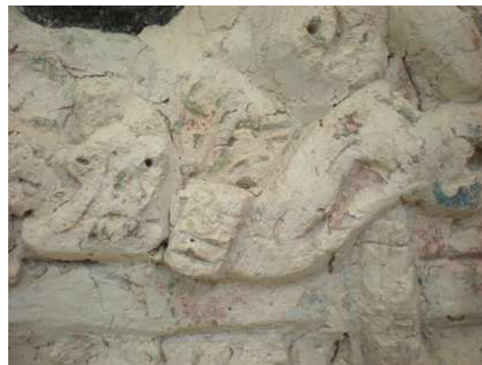
Ilustración 19: Detalle de estucos in situ. Se notan los resanes invadiendo parte del original. Fotografía: Luisa Straulino
