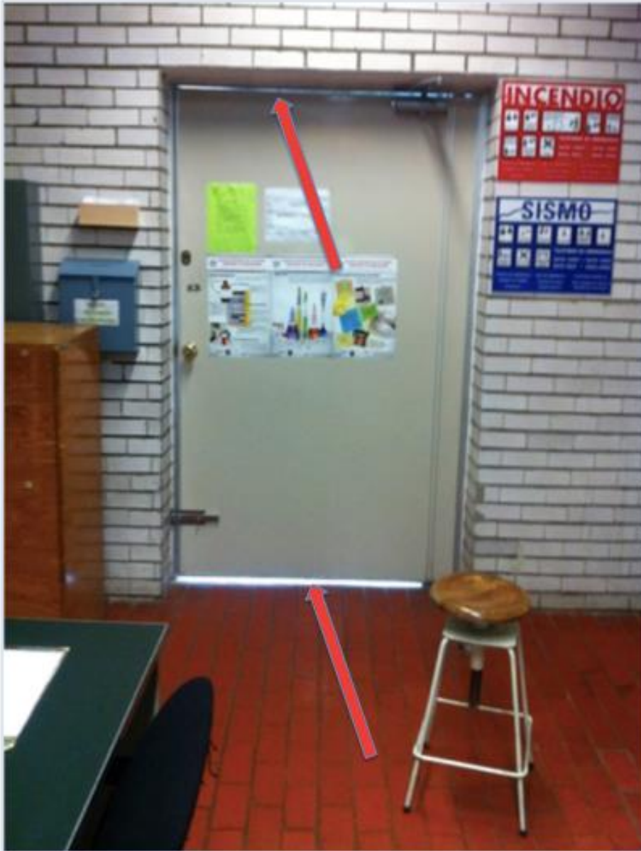
Figura 3.27 Puerta del laboratorio sin aislamiento acústico
