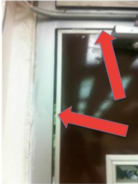
Figura 3.8 Puerta del salón D004 sin aislamiento acústico
