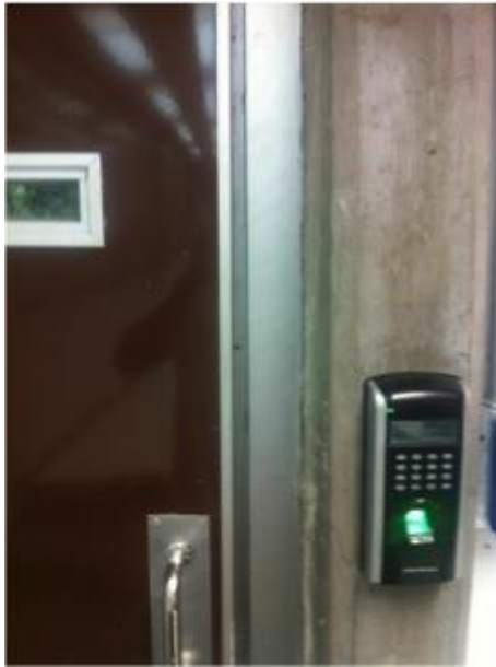
Figura 3.18 Puerta del salón J110 sin aislamiento acústico
