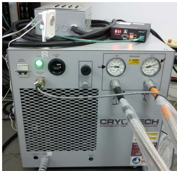
Figura 4.20: Criocompresor CRYOMECH (modelo CP830) utilizado para enfriar los detectores dentro del dewar. Sobre el compresor se encuentran también una cámara TPLink (al frente) y relevador de potencia (detrás), a un lado está colodo un amperímetro
