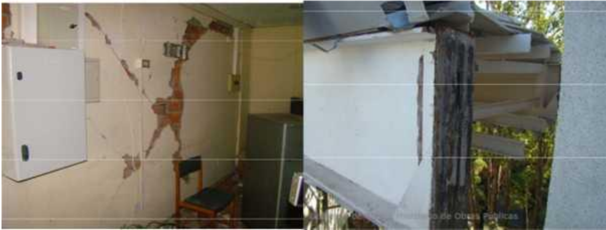
a) Falla muro
