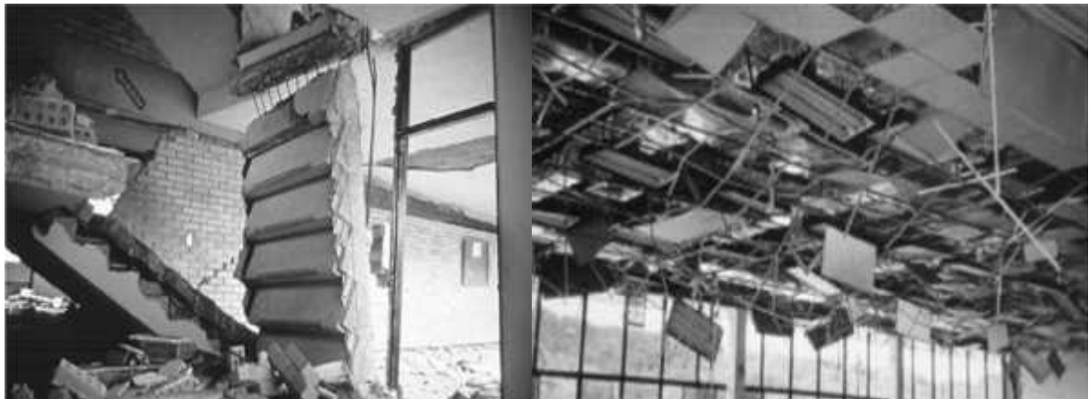
a) Falla de escalera
