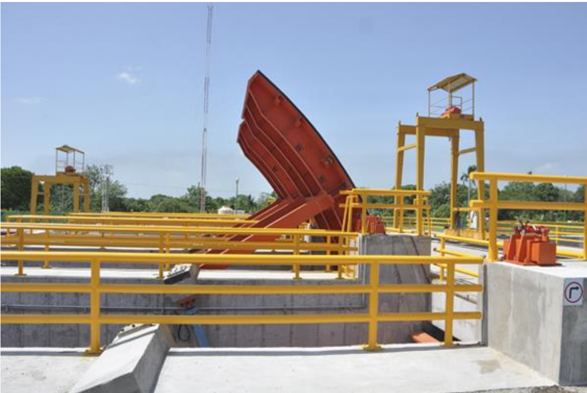
Figura 1.1 Compuertas radiales de la estructura de control El Macayo
