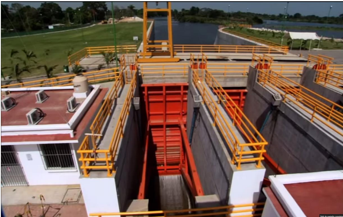
Figura 5.1 Compuertas radiales de la estructura de control El Macayo, canal de la margen derecha
