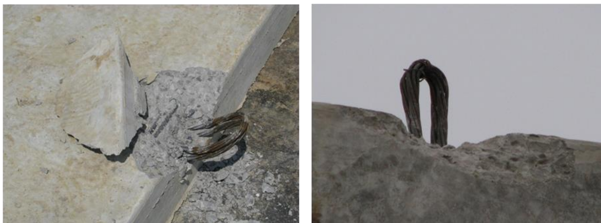
Figura 4.15 Daños causados en el elemento por la aplicación de esfuerzos en los puntos de izaje.
