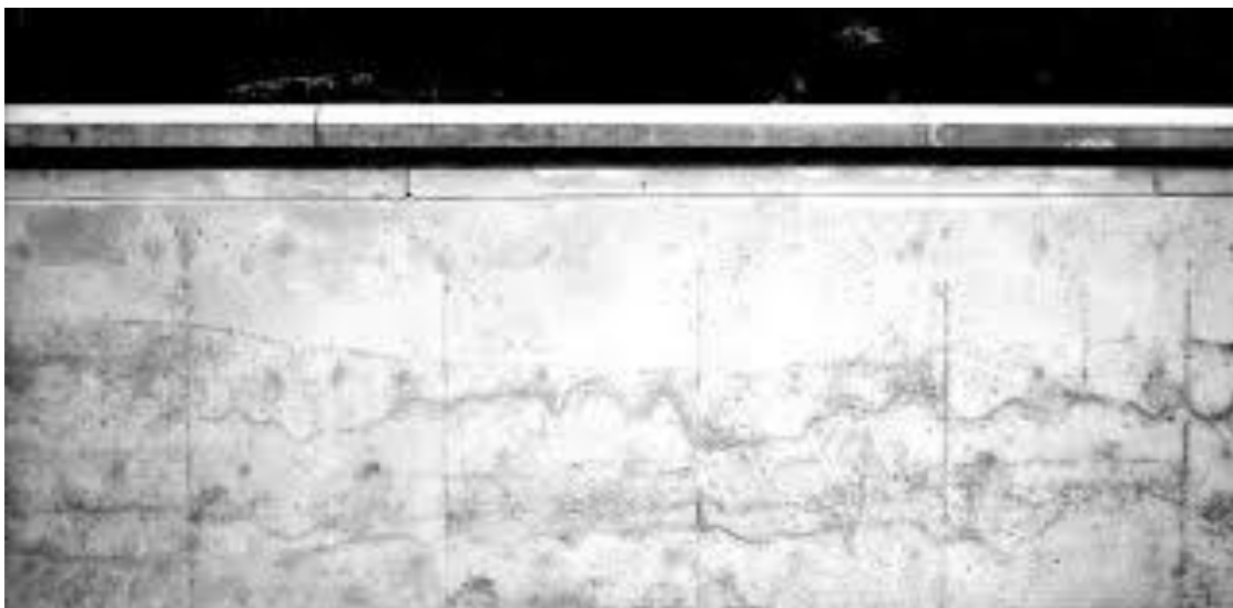
Figura 5.7 Líneas de flujo que pueden ser confundidas muy a menudo con juntas frías, pero que se evitan con una secuencia planeada de colado, una disposición adecuada y suficiente de equipos de colocación y las prácticas de vibrado descritas.
