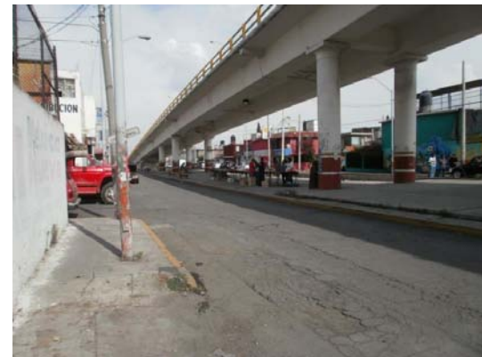
Imagen 3. Boulevard Teocallis. Puente proyectado a partir de la Línea B del Metro
