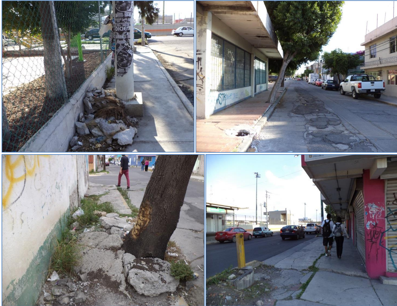
Imagen 35. Desperfectos en la infraestructura vial en Ciudad Azteca. Las malas condiciones y los obstáculos físicos en aceras provocan que el usuario camine sobre la superficie de rodamiento, que también presenta problemas de hundimiento y baches.
