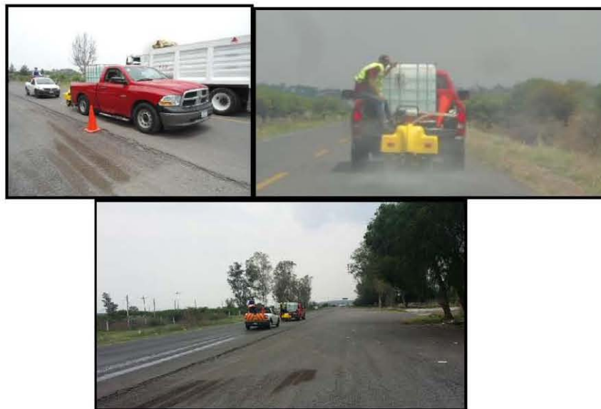
Figura 11 Equipo en verificación durante el proceso de medición de la fricción en tramo de referencia.
