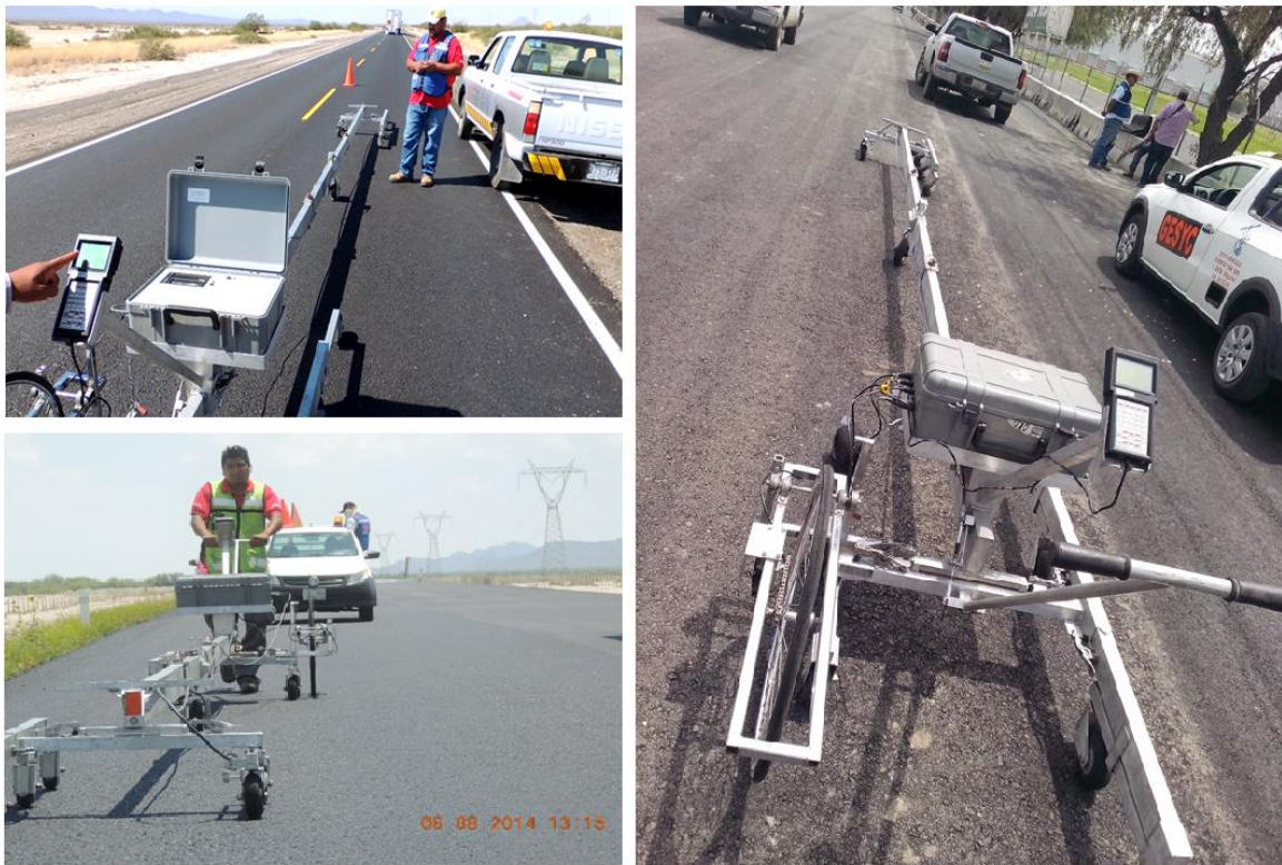
Fotografía 6.1 Perfilógrafo computarizado Tipo California de la marca Ames Engineering utilizado para determinar la Rugosidad del Pavimento.
