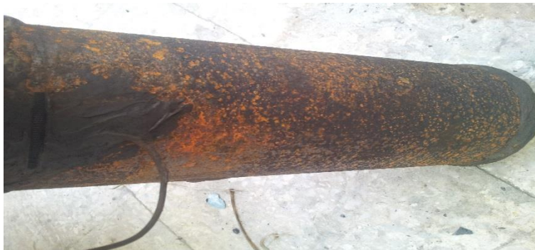
Fig. 56 Ducto después de la prueba a presión 1000 psi.
