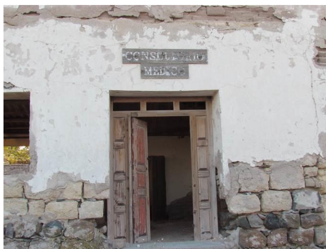
Figura 4.42 Entre las construcciones que se encuentran en pie hasta nuestros días se encuentra el consultorio médico.
