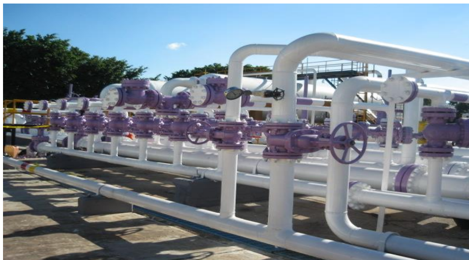
Figura I.2 Cabezal general de llegada de pozos
