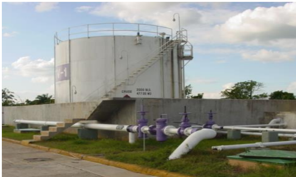
Figura V.1 Tanque de almacenamiento
