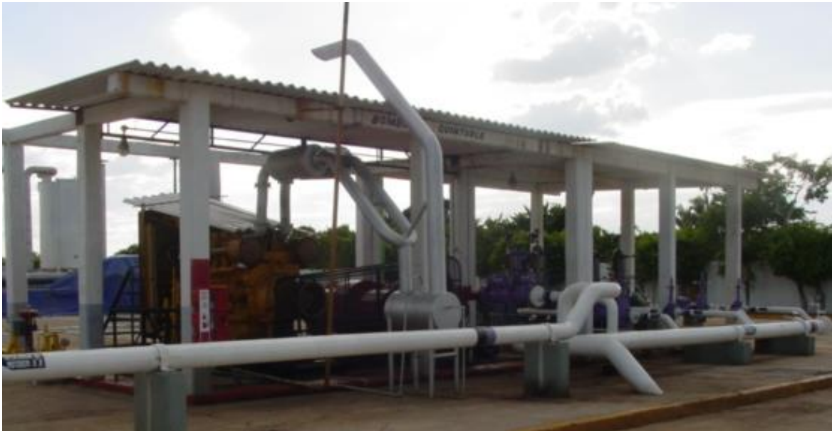
Figura V.2 Casa de bombas
