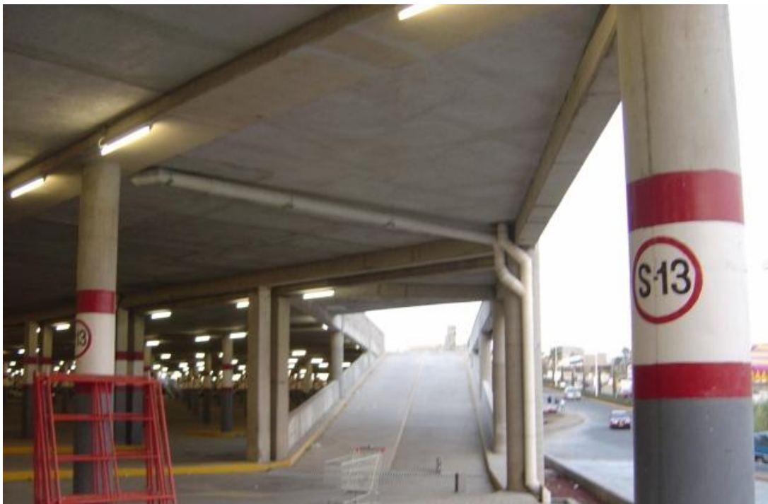
Figura 36 Bajadas pluviales en estacionamiento cuerpo B.
