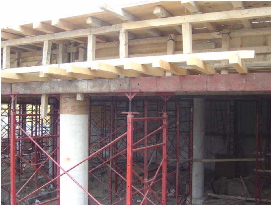
Figura 35 Cimbra cuerpo "B". Se observan claramente pies derechos, vigas madrina, polines y cama de triplay.
