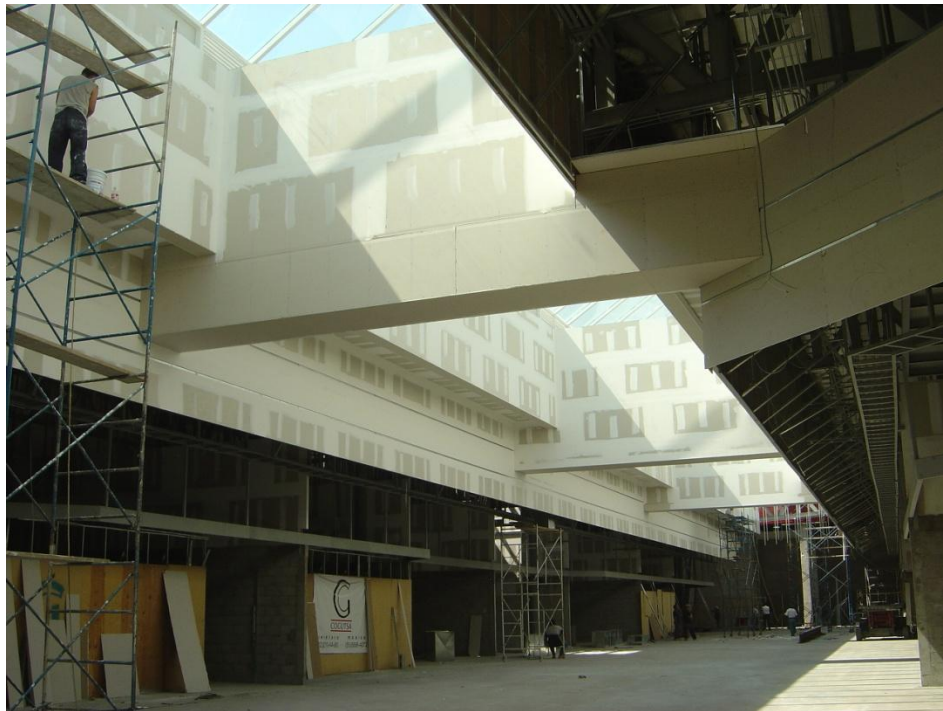
Figura 25 Colocación de paneles de yeso en faldones y plafones falsos de áreas comunes, previo a la aplicación de pintura vinílica.
