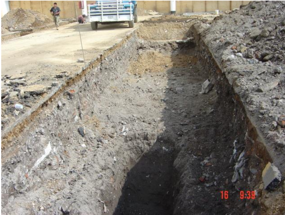
Figura 22. Relleno heterogéneo en cepa de cimentación eje 15 (junta constructiva entre ambos edificios.
