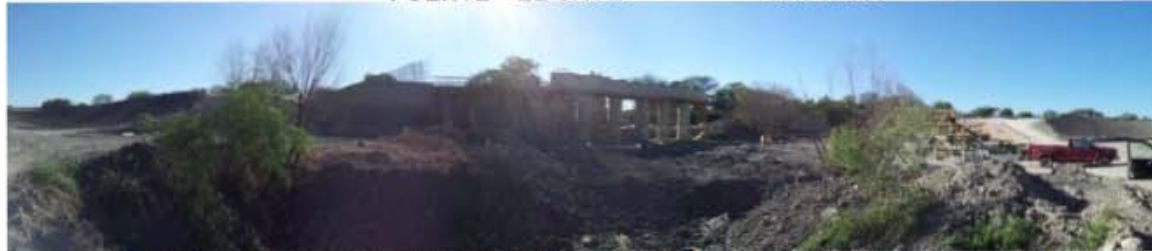
CARGADOR CENTRAL COLADO. PREPARANDO EL ACERO PARA EL CARGADOR IZQUIERDO, CIEMBRA PREPARADA PARA COLAR EL ESTRIBO DERECHO
