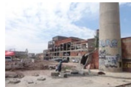
6. Estructura en mal estado
