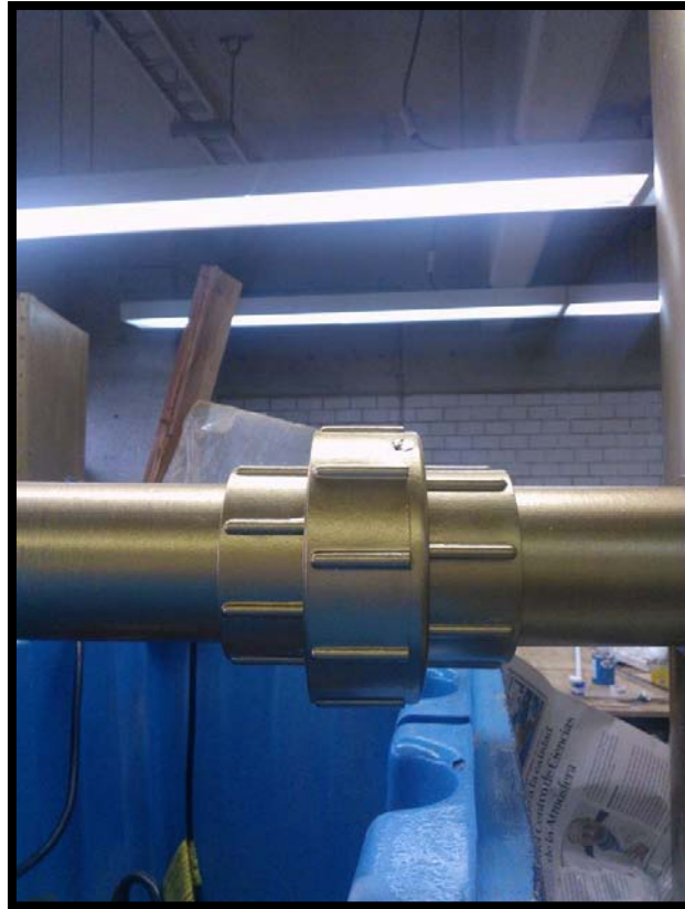
Figura 3.31 Tuerca unión usada en la instalación de alimentación. (Noviembre 2014).
