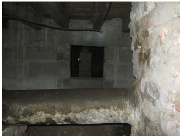
Imagen 51 casa 196 interior del semisótano, fotografía tomada por el Arq. José Antonio de Fuentes Reyes (2012)
