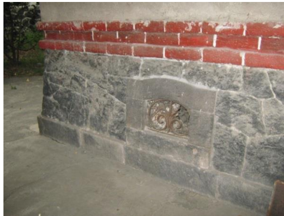
Imagen 49 casa 197 ventanas del semisótano, fotografía tomada por el Arq. José Antonio de Fuentes Reyes (2012)
