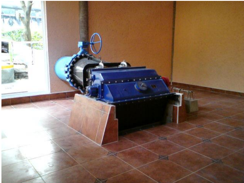
Foto A2-12 Vista de turbina, válvula y acabado de piso.
