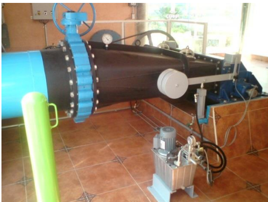
Foto 5.1.5 Válvula y toma de agua
