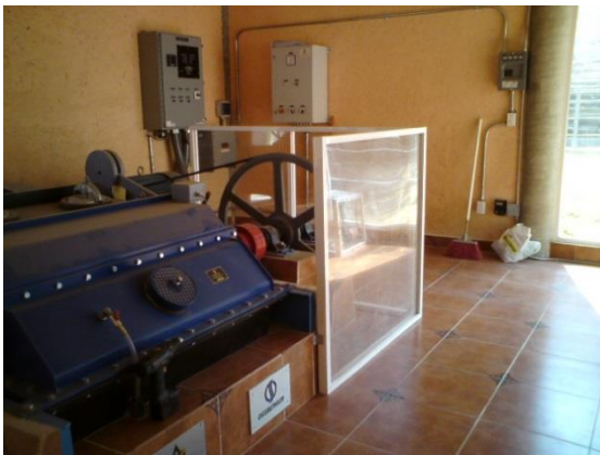
Foto 5.1.3 Turbina y polea
