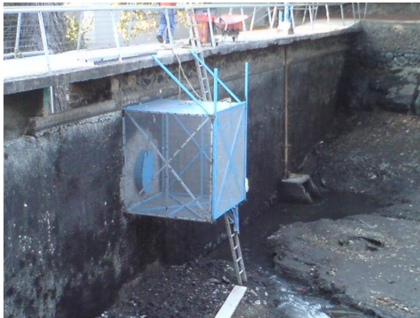
Foto A2-04 Vista de protección de toma y compuerta de desfogue.
