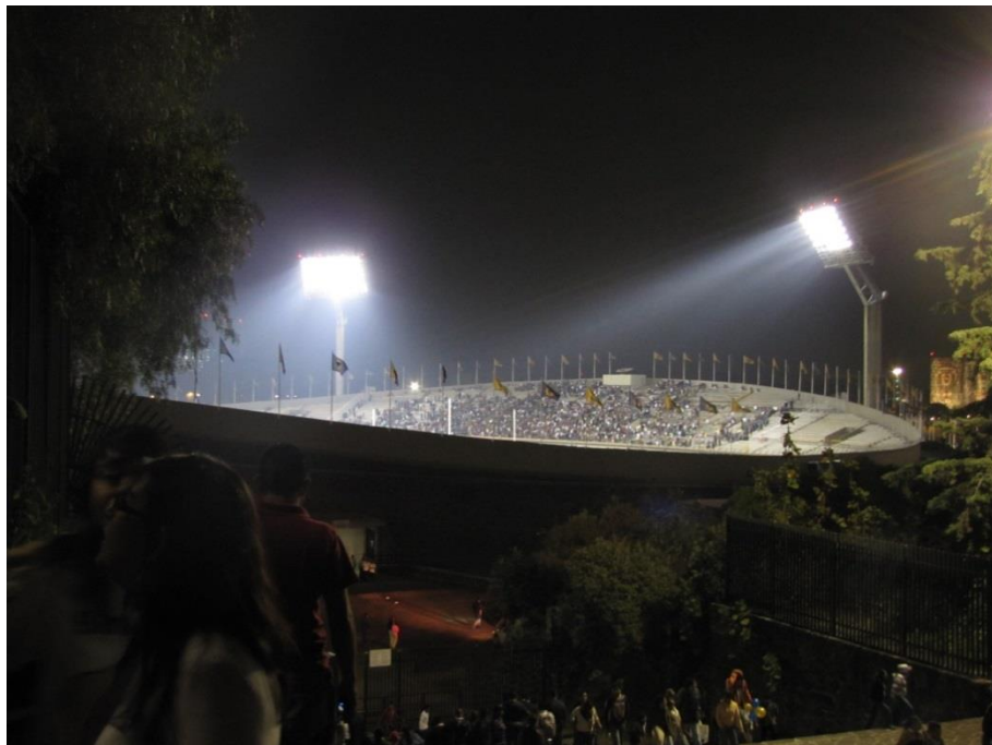
Fotografía 2. 3. Torres con nuevas luminarias.
