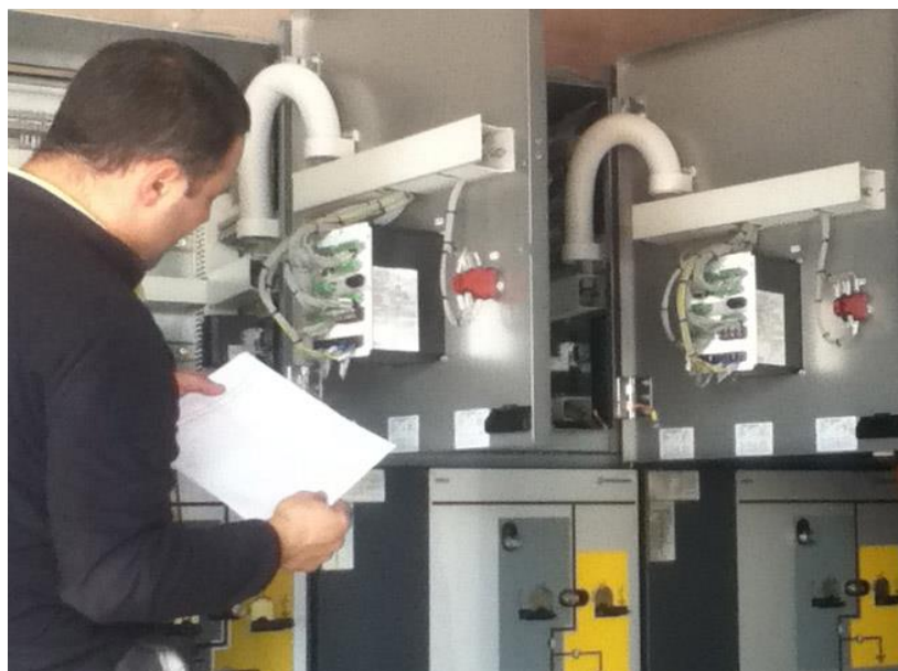
Fotografía 3. 4. Instalación del sistema de protección de alimentador SEL-751A .
