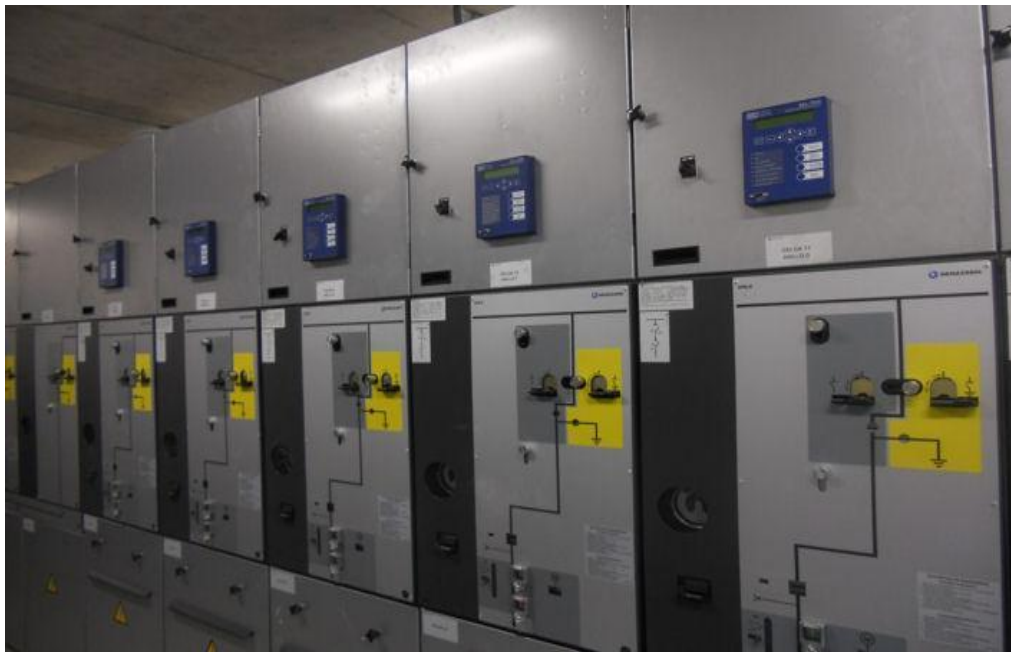
Fotografías 3. 2. Celdas modulares Ormazabal tipo GIS , modelo CPG.O . Subestación General No. 6.
