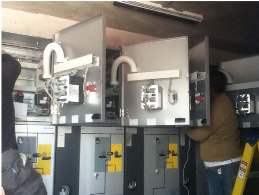
Fotografías 3. 3. Instalación de tableros generales Ormazabal tipo GIS , modelo CPG.o . Subestación General No. 6.
