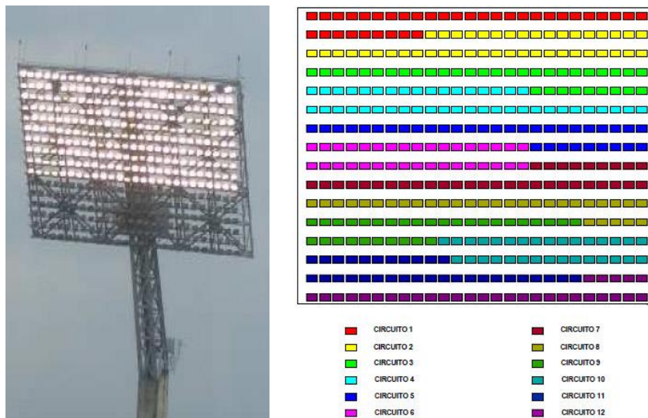
Figura 2. 6. Torre de iluminación (al 62.5%) y circuitos de encendido. 14
