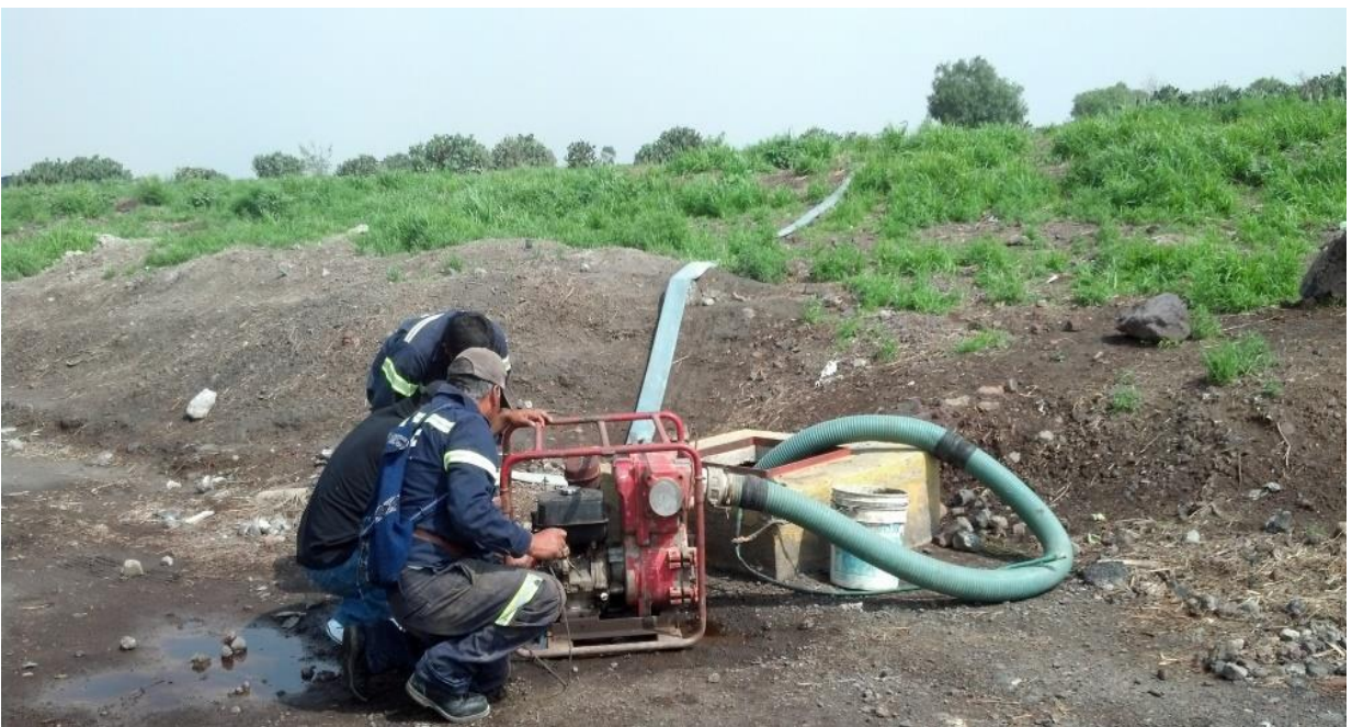
Figura 3-13. Preparación del sistema de bombeo portátil para la recirculación de lixiviado en la Etapa 2.
