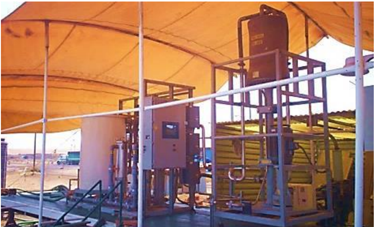
Figura 3-17. Planta de tratamiento de lixiviado por osmosis inversa en la Etapa 4.
