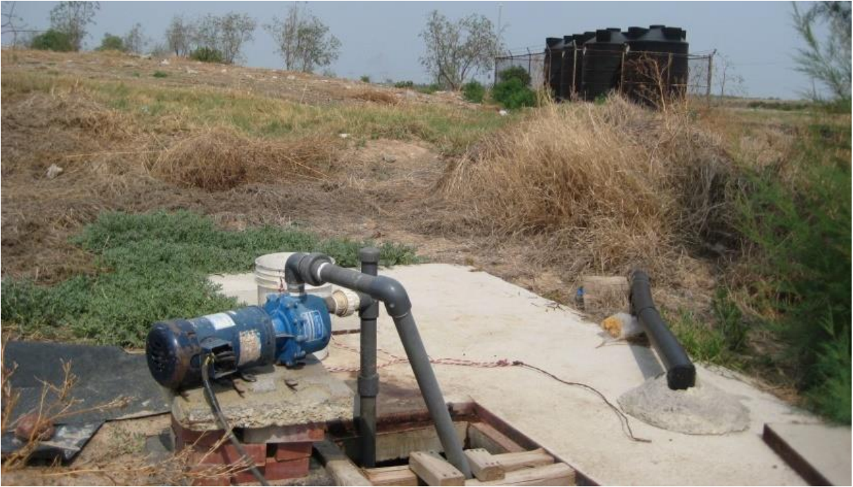
Figura 4-2. Pozo de extracción y monitoreo de lixiviado en la Etapa 1.
