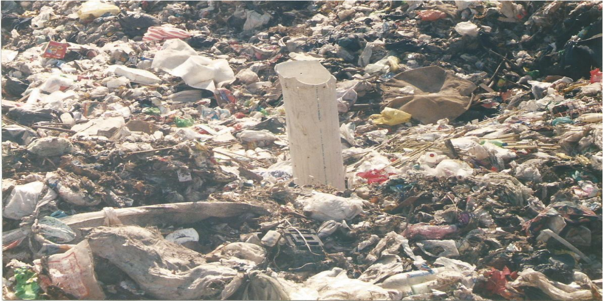
Figura 3-12. Vista parcial de la instalación de infraestructura para la recirculación de lixiviado.
