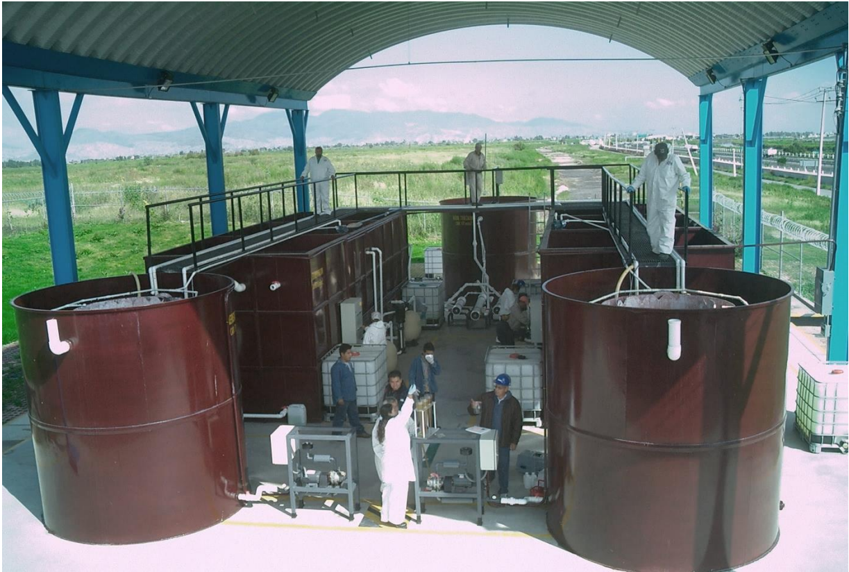
Figura 3-16. Planta de tratamiento fisicoquímico de lixiviado en la Etapa 2.
