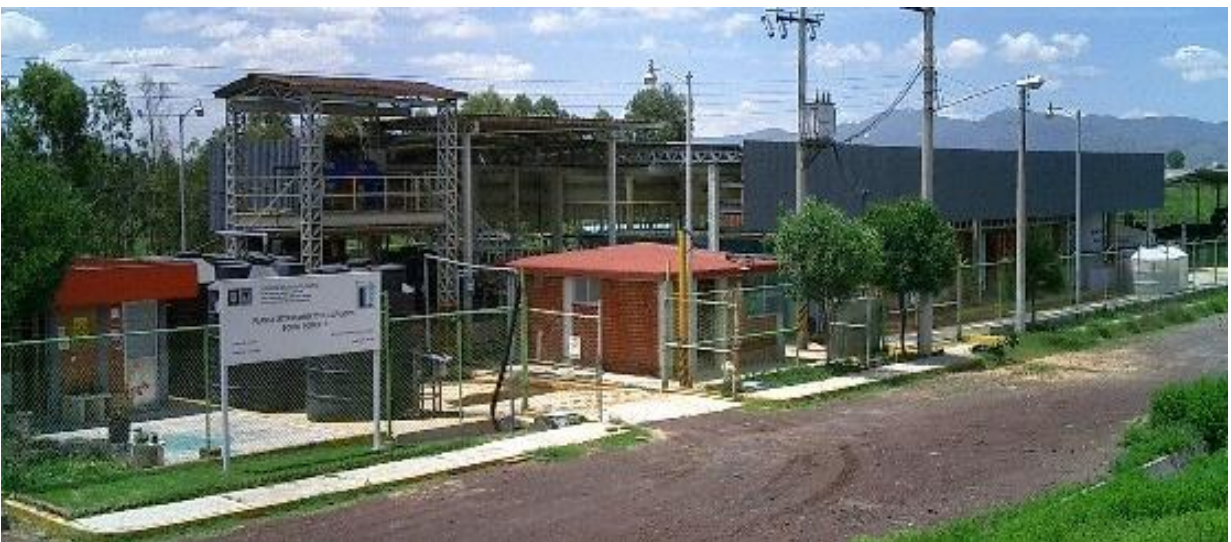
Figura 3-15. Planta de tratamiento fisicoquímico de lixiviado en la Etapa 1.
