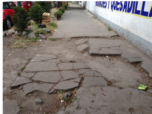
Pavimento en malas condiciones.
