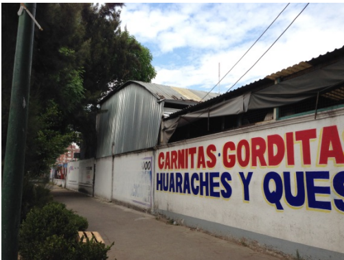
Autoconstrucción en mal estado.
