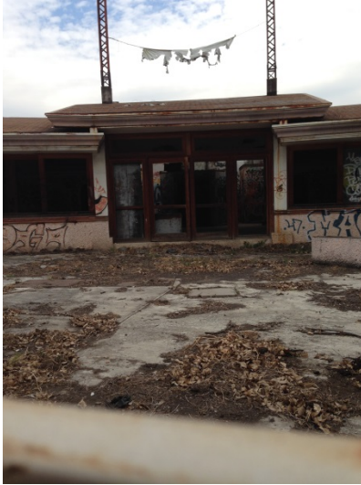
En la esquina de ambas Calzadas, se encuentra ésta construcción, en pésimas condiciones y fomenta el vandalismo.
