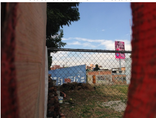
Vista actual al interior del predio. Se observa acumulación de materiales, mal estado de los muros existentes.
