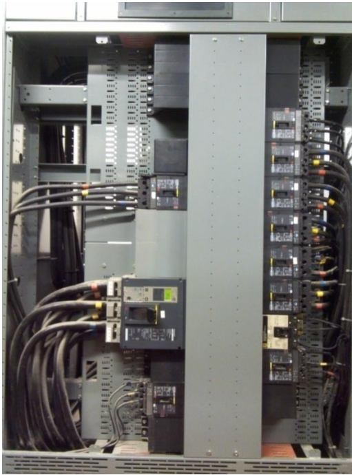
Imagen 2.11 Tablero general subestación.
