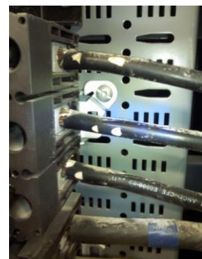
Imagen 2.14 Daño en aislamiento
