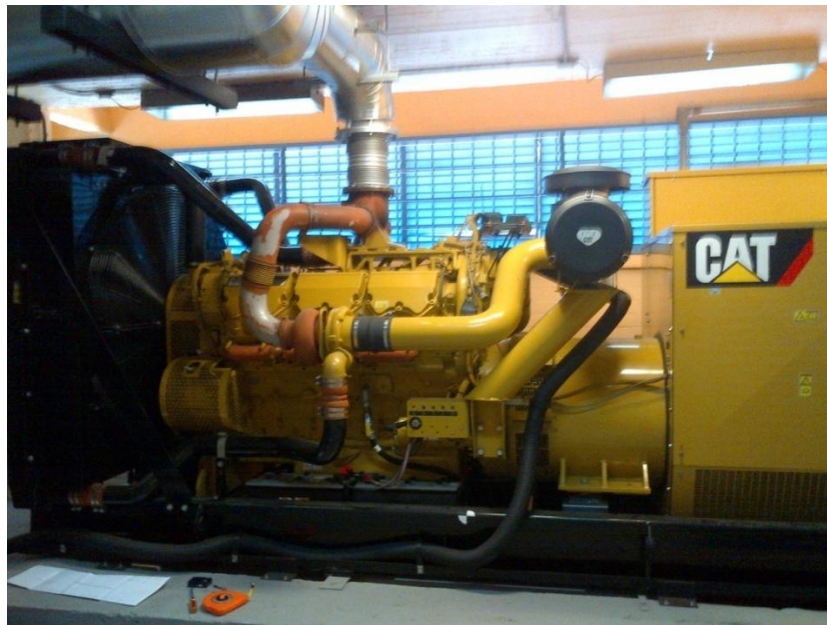
Imagen 2.8 Planta generadora (emergencia)
