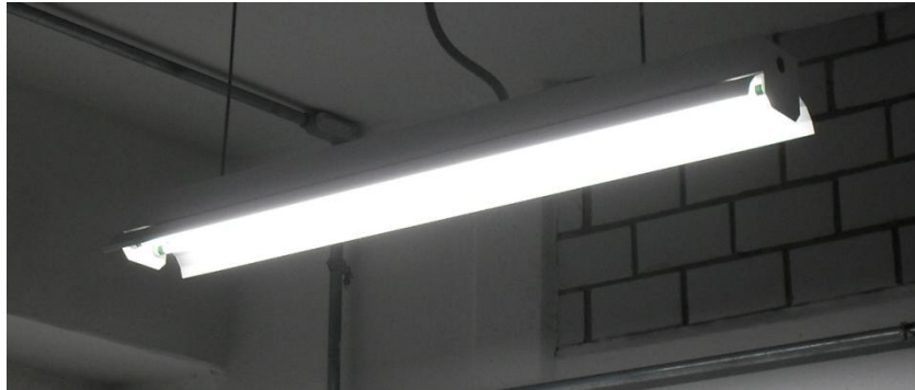
Imagen 2.7 Luminaria en la subestación.
