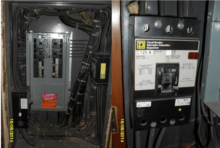
Imagen 2.48 y 2.49 tablero e interruptor 3A
