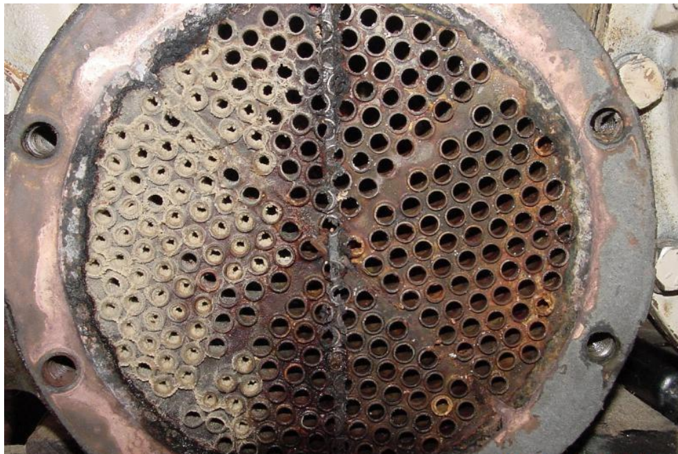
Figura 2.25. Ensuciamiento en un equipo de tubos y coraza, a la izquierda se muestran las incrustaciones y a la derecha el equipo limpio.
