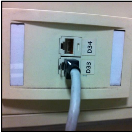
Figura 2. 10 Roseta en canaleta lateral
