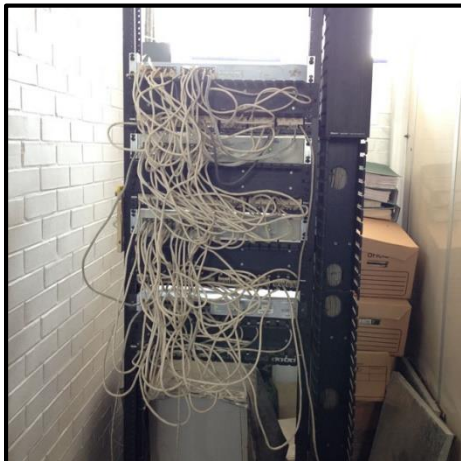
Figura 2. 18 Rack y cableado de patch panel - switch
