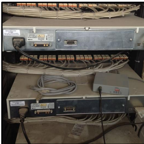
Figura 2. 20 Switches y cableado de patch panel
