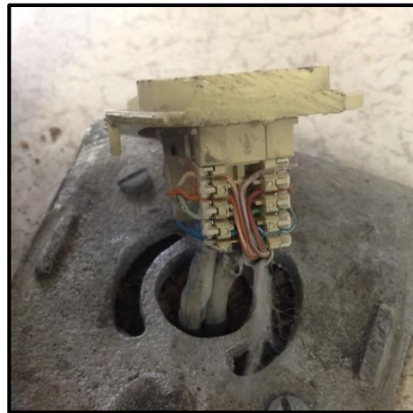
Figura 2. 13 Revisión de conectores de rosetas de piso
