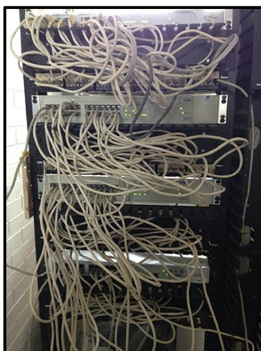
Figura 6. 1 Instalaciones previas en el rack
