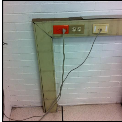
Figura 2. 5 Entrada al piso falso de canaleta de área de trabajo
