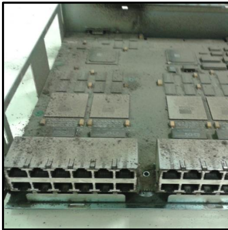
Figura 4. 5 Vista de las interfaces del switch
