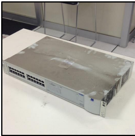
Figura 4. 1 Switch desmontado, previo al mantenimiento
