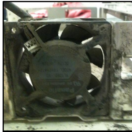
Figura 4. 6 Ventilador del switch
