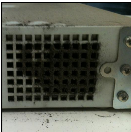
Figura 4. 7 Orificios de ventilación obstruidos por el polvo
