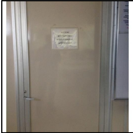
Figura 2. 16 Área de telecomunicaciones, acceso
