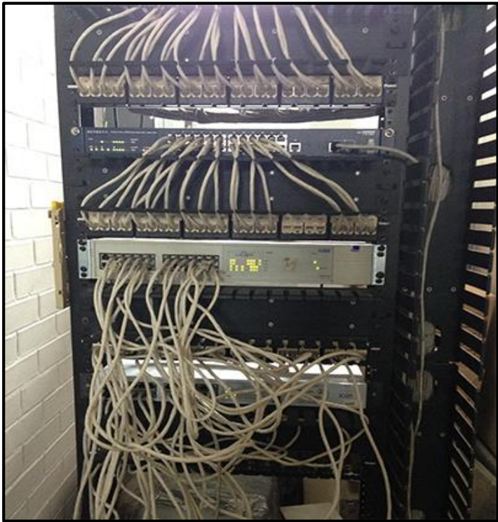
Figura 6. 3 Instalación del segundo switch
