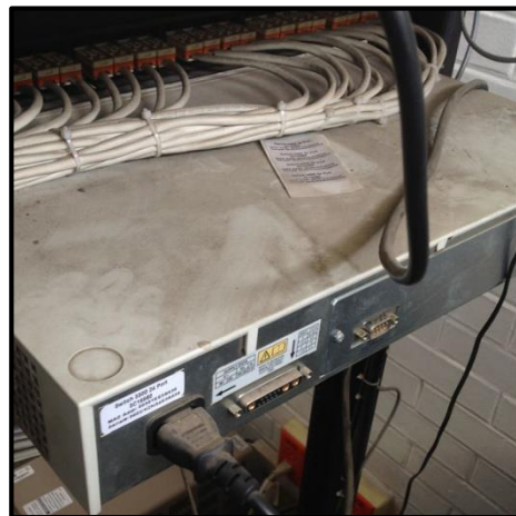
Figura 2. 21 Condiciones físicas de los equipos de comunicación
