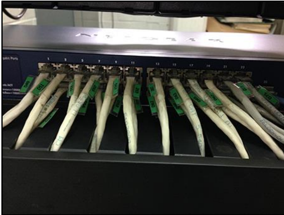
Figura 6. 8 Etiquetado de conexiones del tercer switch
