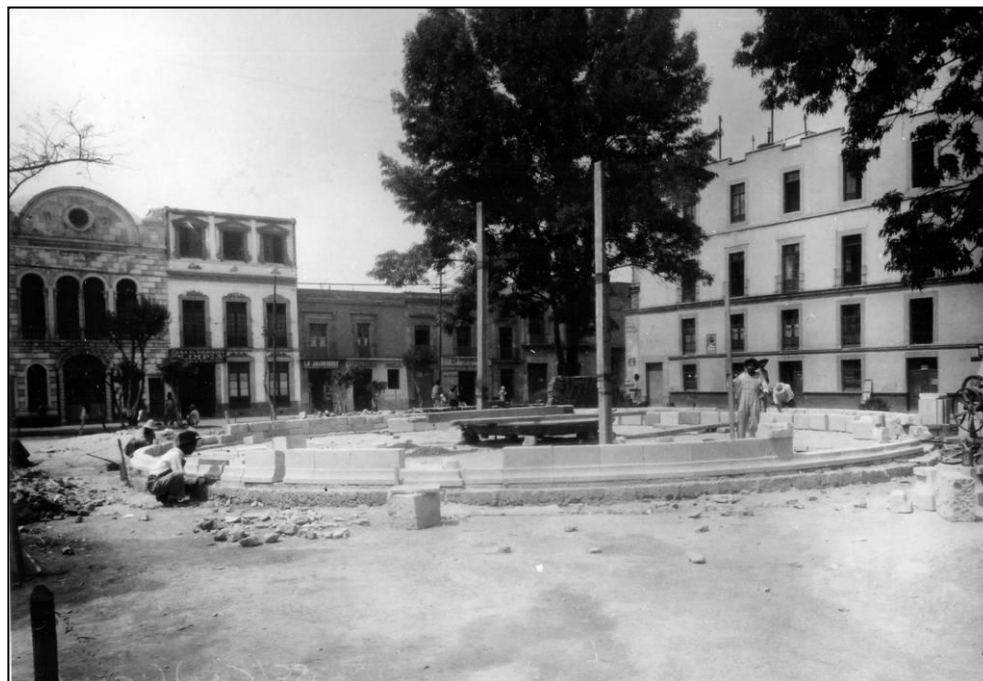
Foto 10. Trabajos de rehabilitación de la Plaza de Loreto, y edificaciones al sur.
