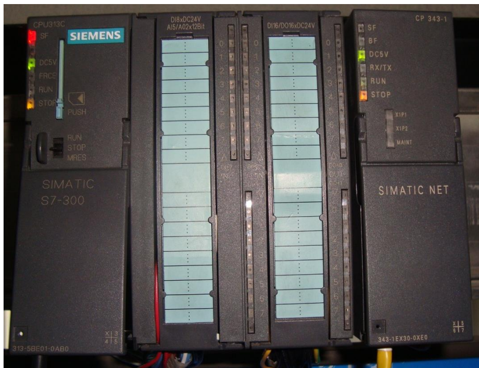
Figura 3.14 PLC S7-300 con modulo Ethernet.
