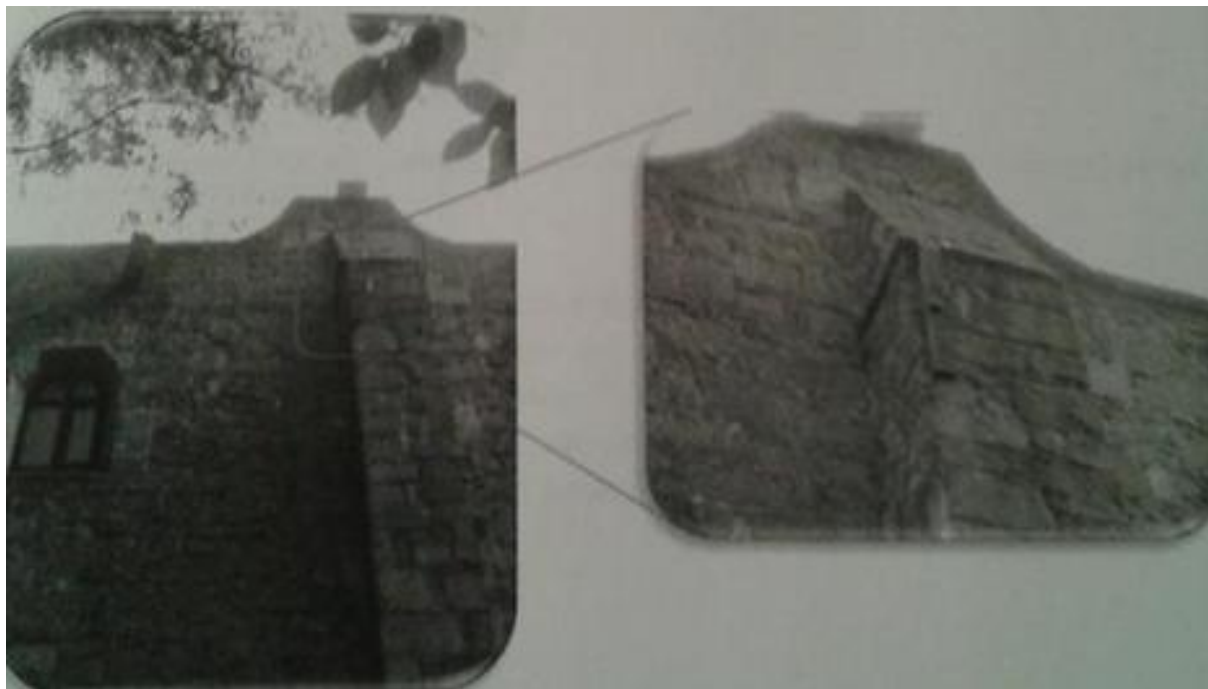
Fig. 22. Vista del refuerzo que se colocó en los muros para evitar que abrieran y provocaran la fractura del arco toral (Gutiérrez, 2011).
