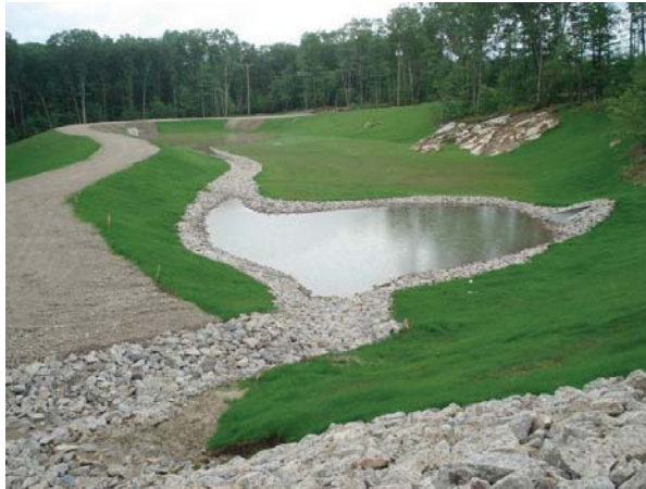
Figura 3-8. Cuenca de infiltración. Fuente: kenmarkturf.com
