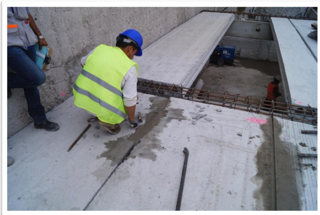
Figura 4.61. Una vez colocadas las losas alveolares en su posición final se realizan los trabajos de junteo (que no es otra cosa que el relleno de las llaves de cortante con mortero cemento-arena).
