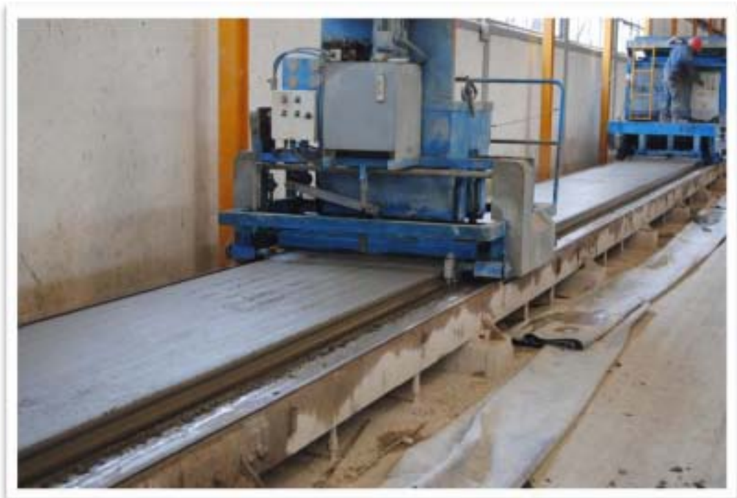
Figuras 4.16 y 4.17. Una vez ajustado el presfuerzo la maquina extrusora cuela toda la longitud de la cama (en este caso 200 m), al final se realizan los cortes en la losa para obtener losas de las dimensiones requeridas.
