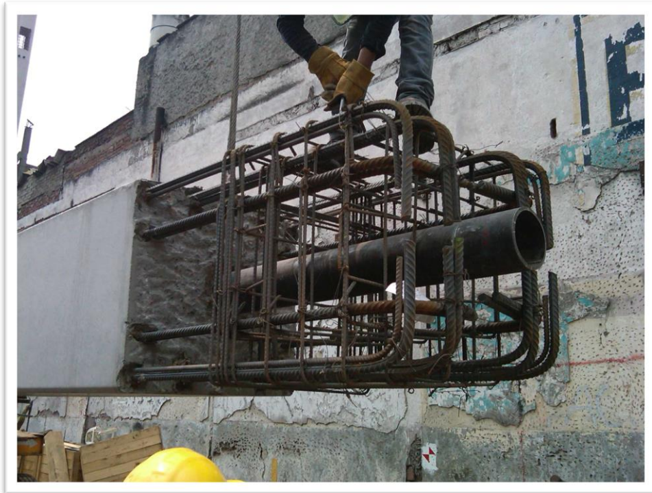
Figura 4.46. En la imagen se puede observar el perno de nivelación que se deja ahogado en la columna prefabricada para poder nivelar y en su caso ajustar la altura (en longitudes pequeñas por imprecisiones de topografía).
