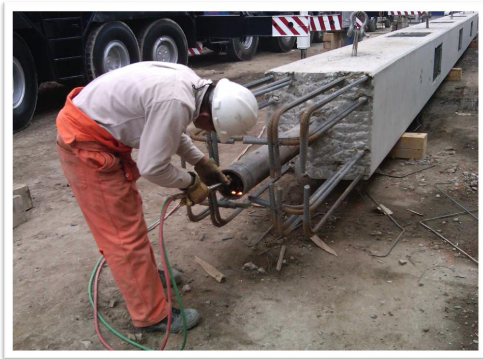
Figura 4.36. Después de revisar los niveles de la placa que recibirá la columna y la altura de esta última se puede ajustar la altura del perno en caso de así requerirse.
