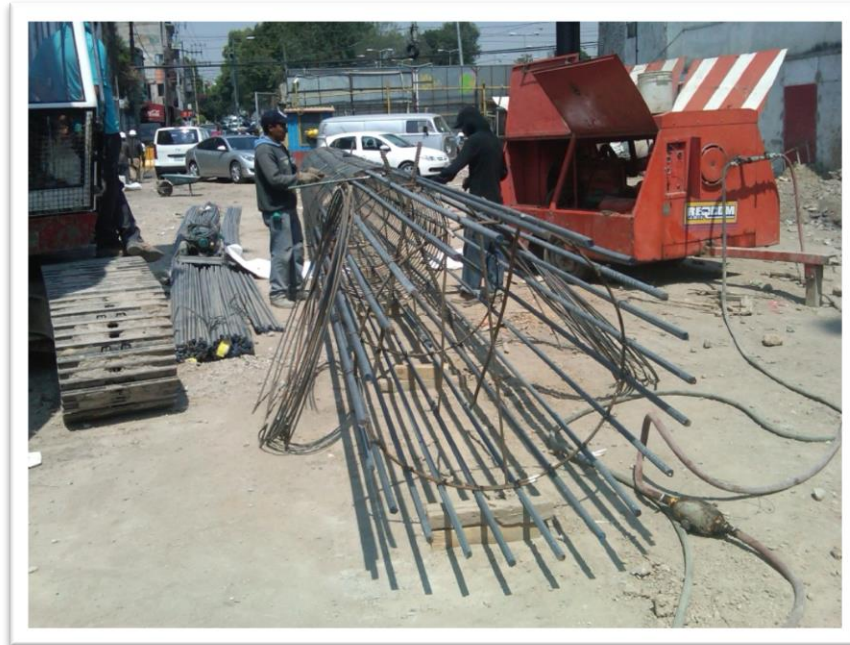
Figura 4.17. Trabajos de armado de acero de refuerzo para pila de 1.20 m de diámetro.
