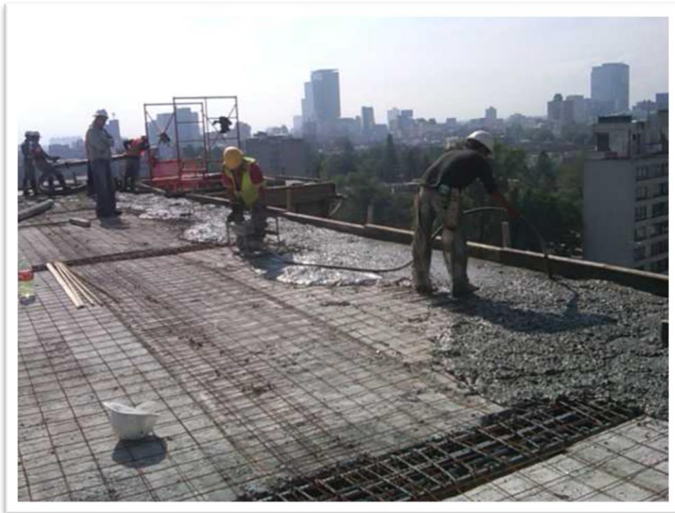
Figura 4.66. Una vez colocada y anclada la malla se realiza el colado del firme, regularmente se manejan espesores de 6 a 7 cm para cubrir las contraflechas de las losas.
