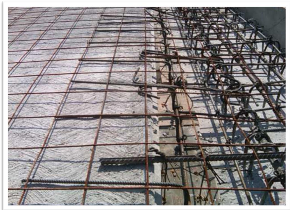
Figura 4.64. Imagen de otro colado de ajuste ya cimbrado. El colado se realiza monolíticamente con el firme de compresión.
