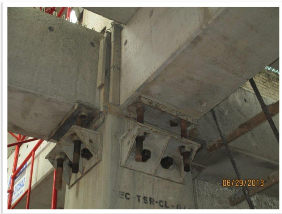
Figura 4.56. Debido a que el nodo de conexión trabe-columna se cuela con concreto de resistencia rápida (80 % de la resistencia nominal a las 72 horas) las ménsulas metálicas se pueden retirar una vez alcanzado ese periodo.
