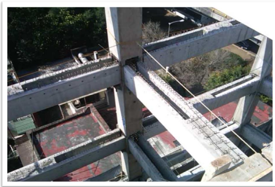
Figura 4.52. En esta imagen se alcanza a observar el “nudo” de conexión que se forma al montar las traves sobre las columnas prefabricadas. Previo a su colado se debe realizar un armado de “continuidad”.
