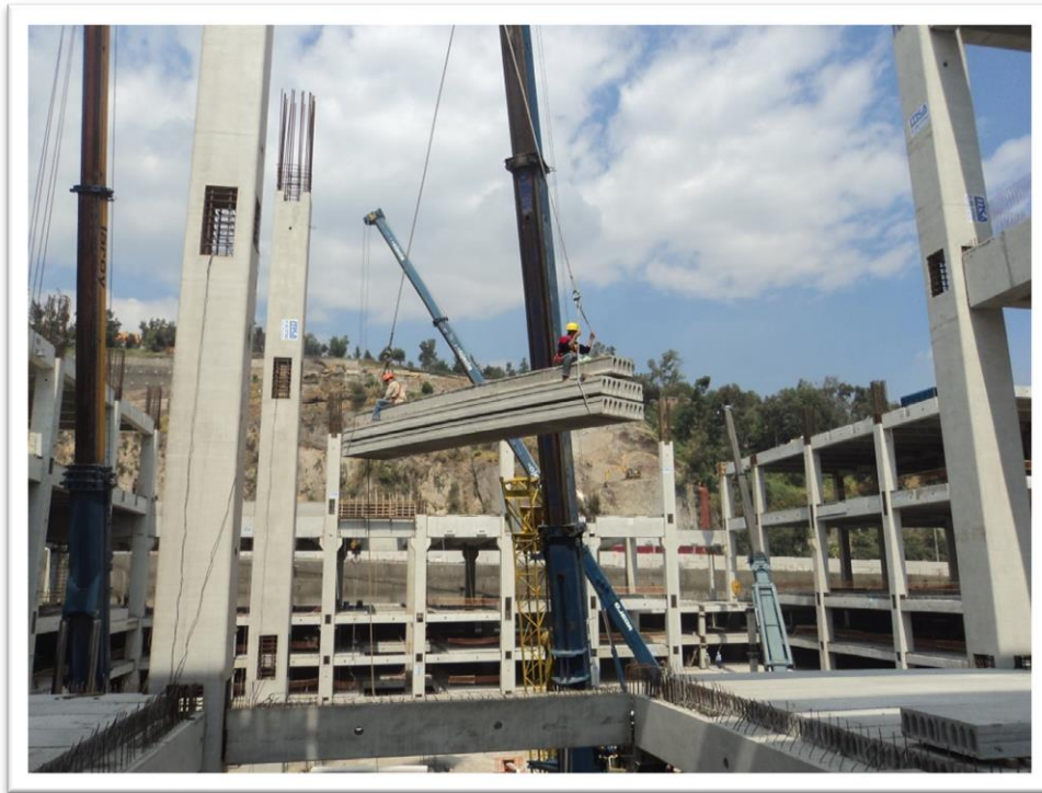
Figura 2.47. Trabajos de montaje de losa alveolar centro comercial gran patio Santa Fe, Ciudad de México (2013).
