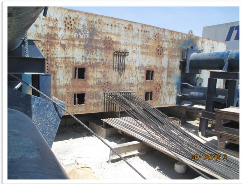
Figura 4.7. El foso o línea de producción debe de contar con cabezales que resistan los esfuerzos de tensión a los que será sometido el acero de presfuerzo de las traveses.
