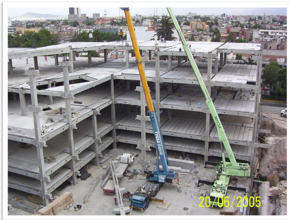
Figura 2.44. Construcción del centro comercial parque Delta solucionado con losa alveolar serie 6000 de 0.15 m de peralte.
