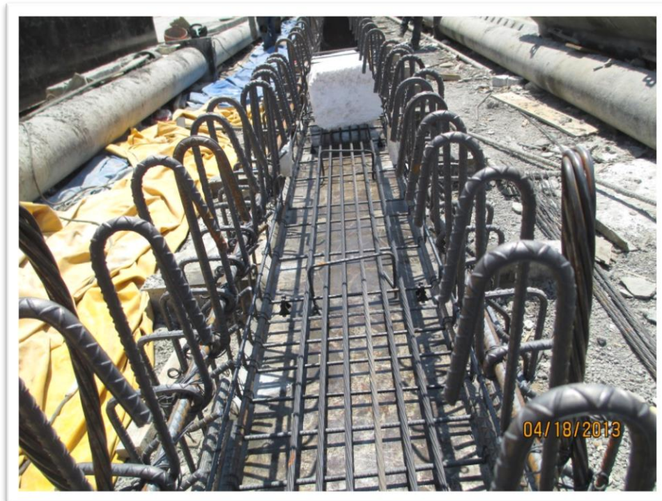
Figura 4.12. Una vez colocado el presfuerzo se realizan los trabajos de tensado del mismo.
