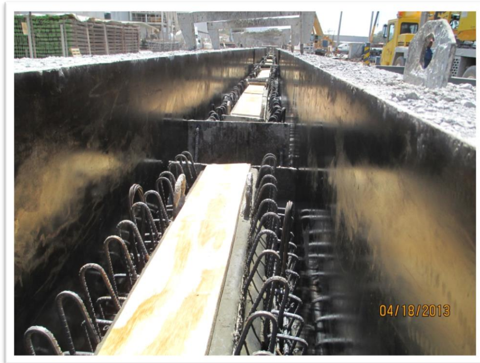
Figura 4.13. Una vez realizados los trabajos de tensado de los torones ya se pueden colocar los costados y tapas.
