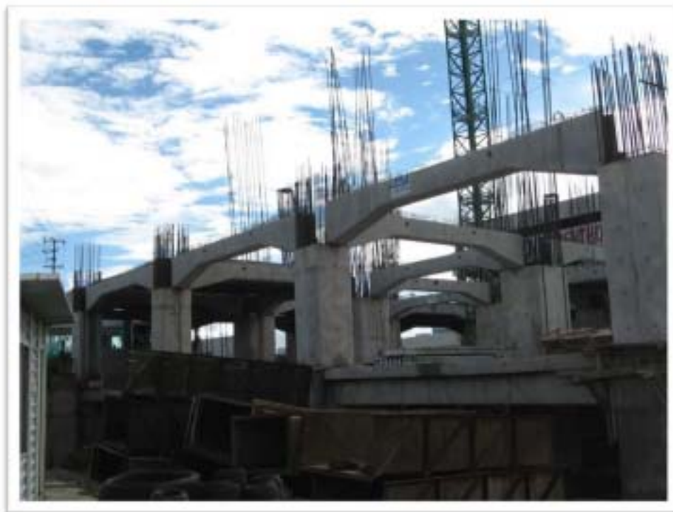
Figuras 2.49 y 2.50. En la imagen se observan traveses portantes tipo TPU acarteladas. Proyecto: torre JV en Veracruz.
