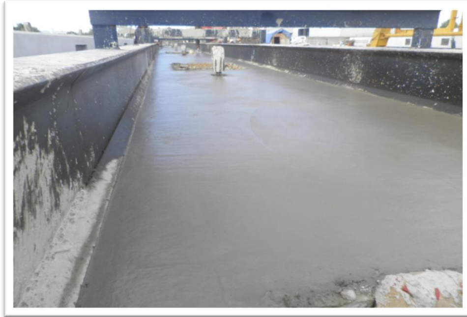
Figura 4.4. Con la línea de fabricación lista y los armados esperando a ser colocados se puede dar inicio con los trabajos de colado, se realiza con concreto de resistencia rápida y se puede colar un elemento diario.
