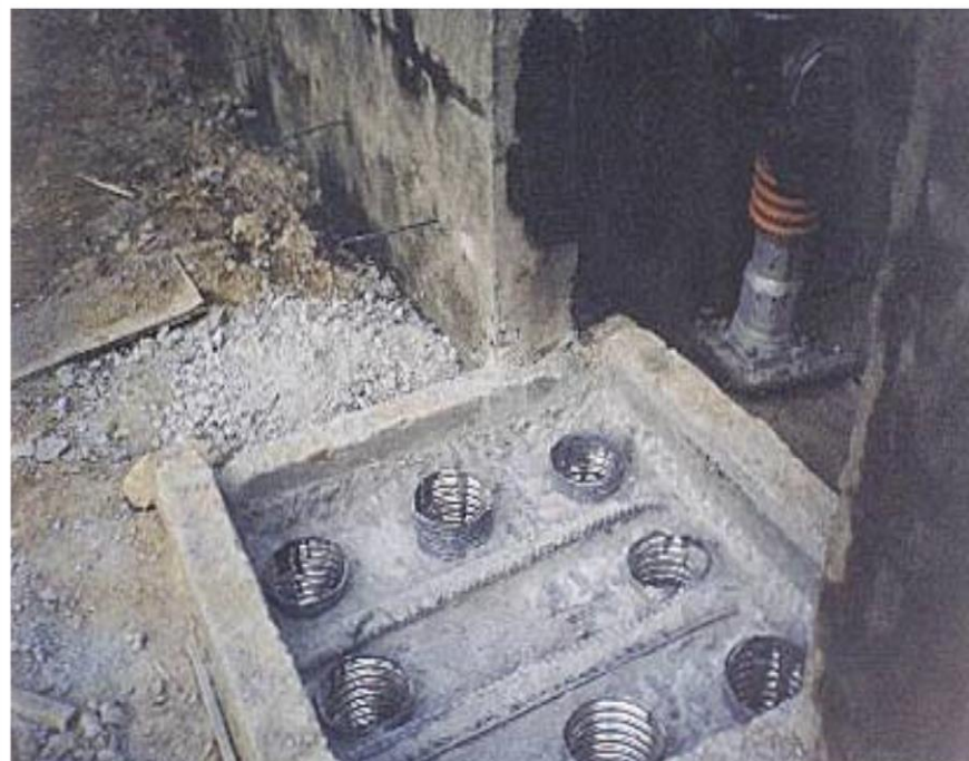
Figura 2.8. Ductos en cimentación para recibir vainas (armado longitudinal de columna). Proyecto: nave electrólisis Peñoles.
