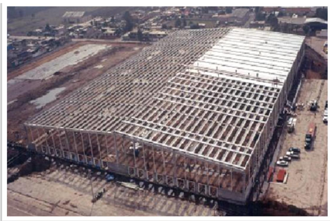
Figura 2.29. Nave industrial “Lerma” en el Estado de México, la estructura utiliza el sistema de Dalias con traves Delta y TI's. área cubierta= 45 000 m 2 .
