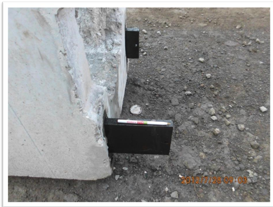
FIG. 2.11. Accesorio metálico tipo cuchilla, es una placa de acero estructural que se deja ahogada en la trabe para apoyarse sobre el nodo de la columna.
