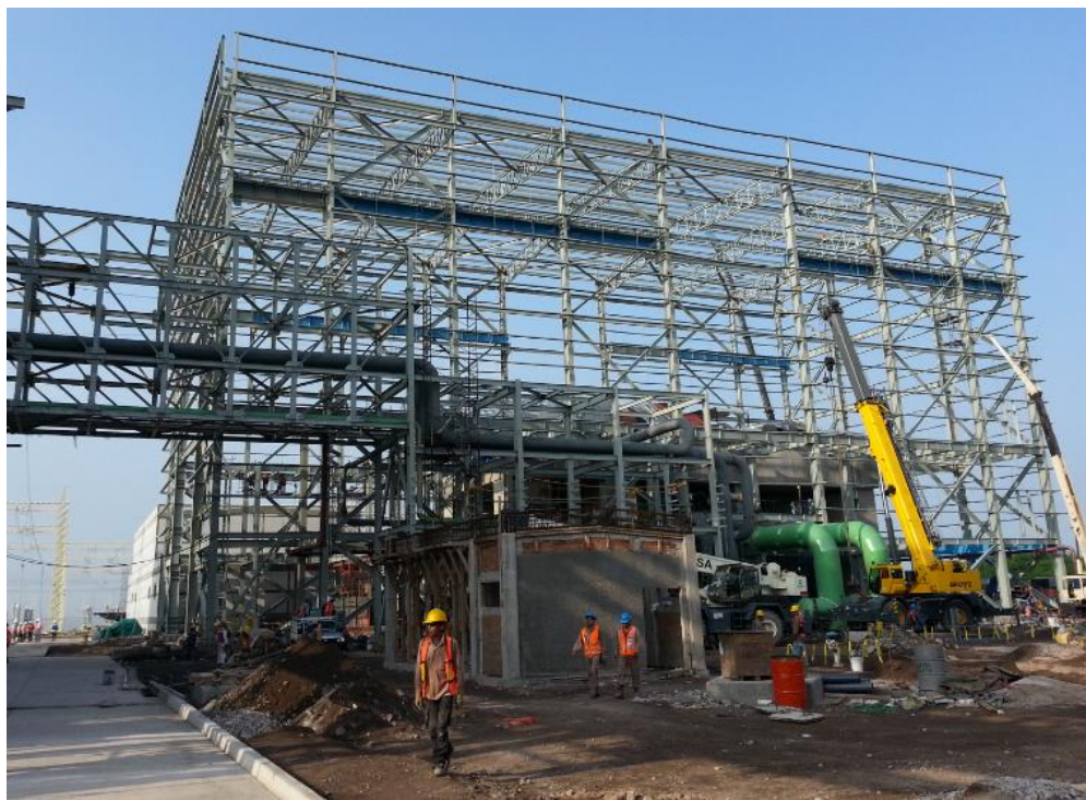
Figura 2.24 Proceso de montaje general de la estructura de la casa de máquinas.
