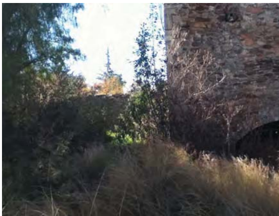
Fig. 5.0.4. Reporte de daño en muros de ex convento: Algunas partes del muro cayeron. Fotografía: Fernando López
