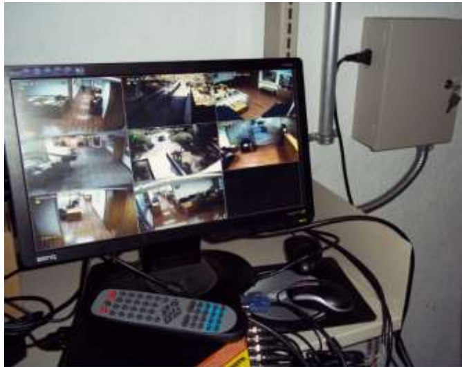
Fig. 3.13 Monitoreo de las 8 cámaras instaladas
