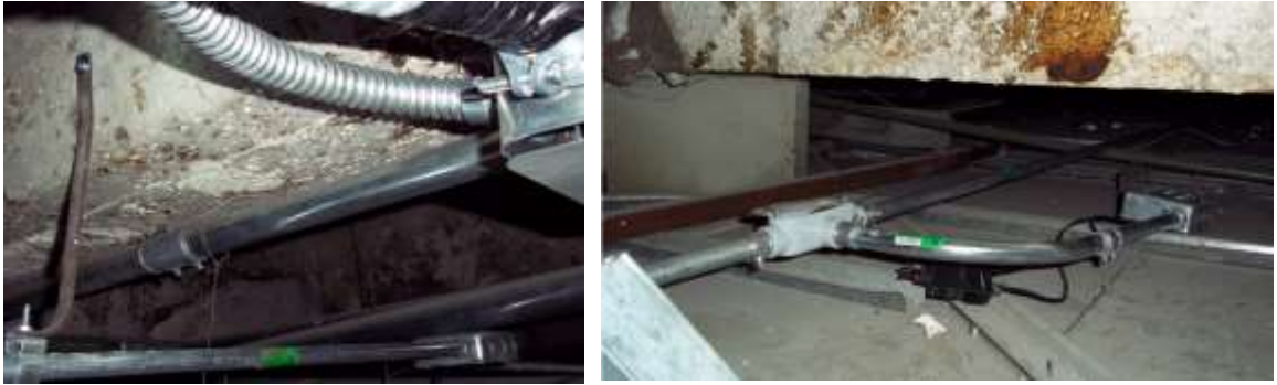
Fig. 3.8 Tubería escondida sobre plafón
