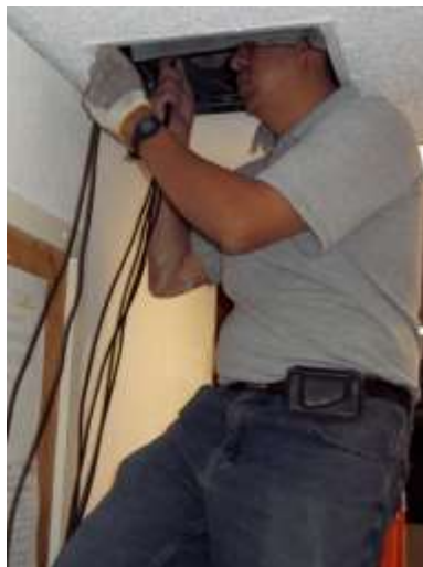
Fig. 3.5 Cableado de cámaras
