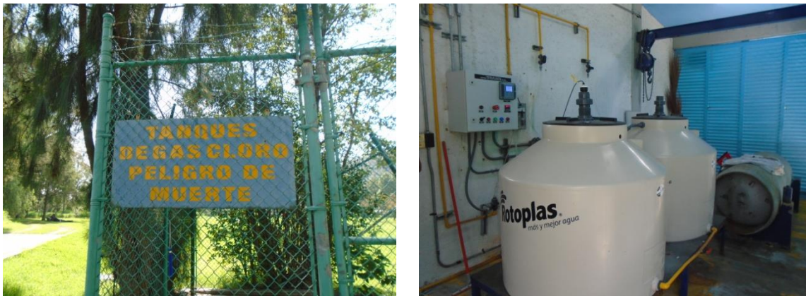
Figura 25 Equipo de desinfección del agua extraída del pozo.
