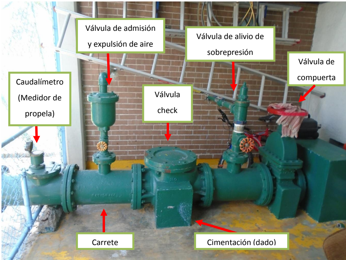
Figura 39 Equipo de bombeo, accesorios y válvulas.
