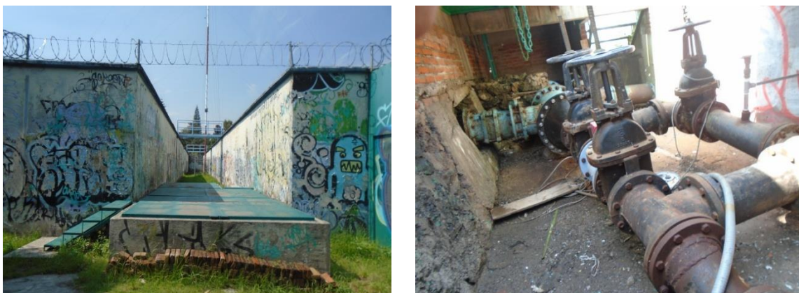
Figura 45 Caja de válvulas entrada a los tanques de regularización.
