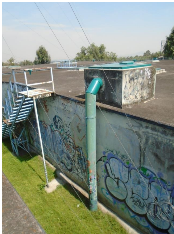
Figura 55 Vista de tubería y descarga libre.
