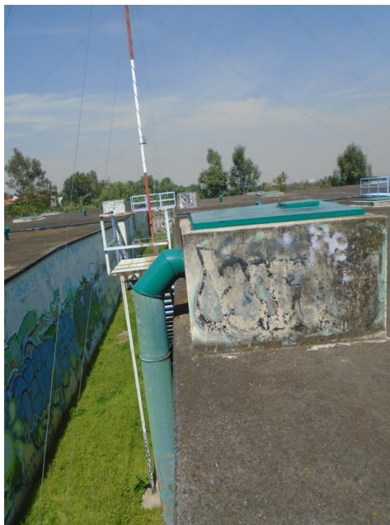
Figura 50 Crucero (29), llegada de la tubería para descarga de agua.
