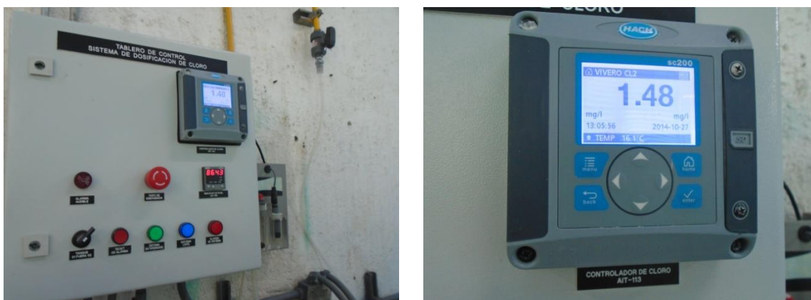
Figura 26 Equipo electrónico para dosificación del hipoclorito.
