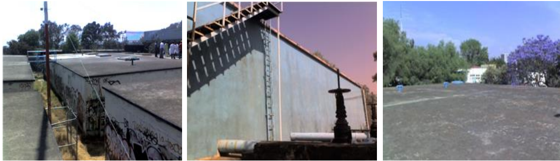
Figura 20 Tanque Vivero Alto, Tanque Alto y Tanque Bajo.
