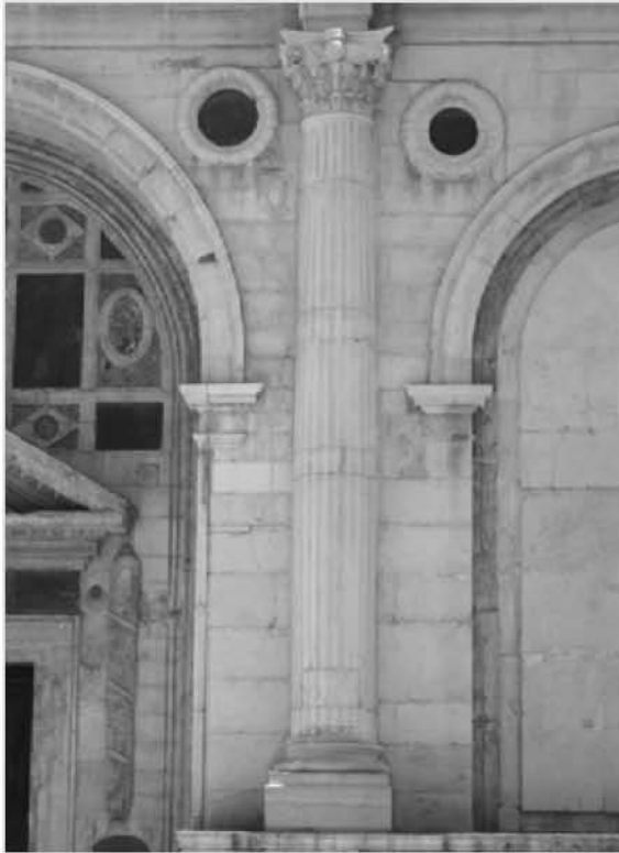
Fig. 56. Leon Battista Alberti, Templo Malatestiano , Rimini, 1447-1450: fachada frontal, detalle de columna y cornisa de imposta primer orden. [foto de la autora].
