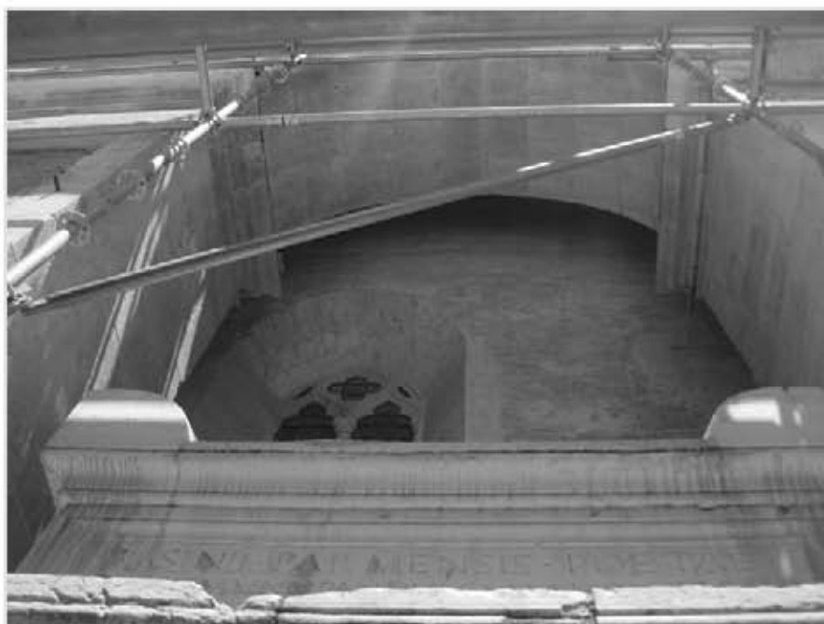
Fig. 39. Leon Battista Alberti, Tempio Malatestiano , Rimini, 1447-1450: fachada frontal, lado sur, detalle de la separación entre el viejo muro de la iglesia y el muro albertiano. [foto de la autora].
