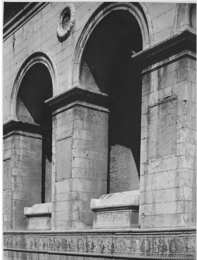
Fig. 33. Leon Battista Alberti, Templo Malatestiano , Rímini, 1447-1450: muro de fachada lateral, detalle arcos, pilares, cornisa imposta, en Paolo Portoghesi, Il Templo Malatestiano , Firenze, Sadea/Sansoni, 1965, p. 7.
