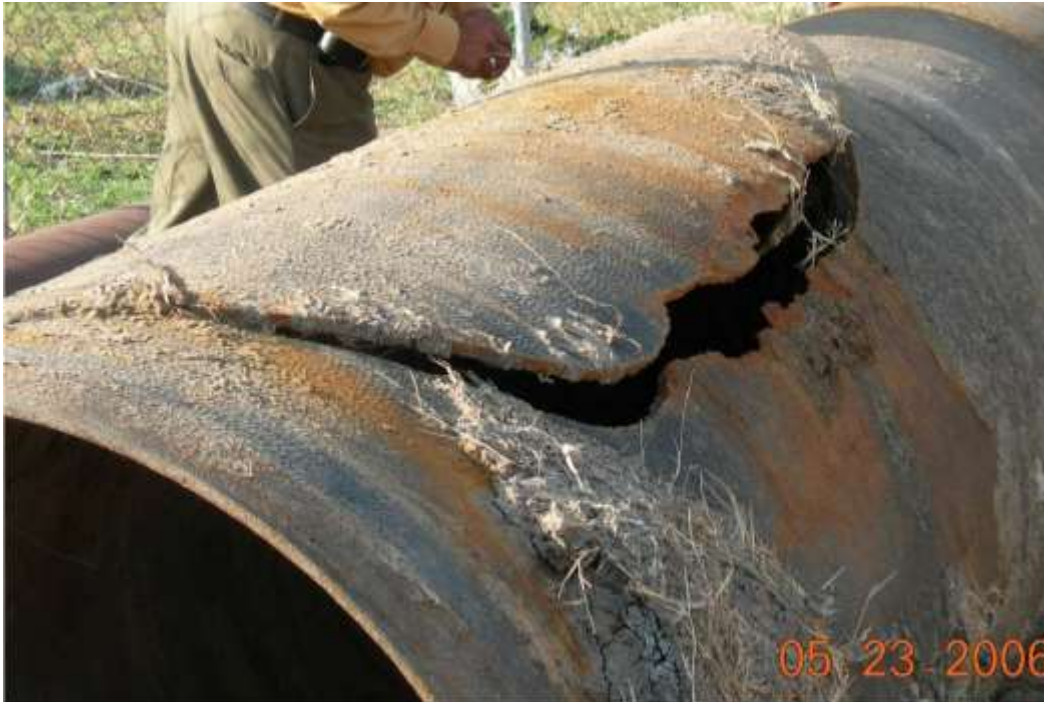
Fig. 3.3 Tubería reventada por el aumento de presión durante un transitorio hidráulico. Acueducto Sta. Rosa, León. 7
