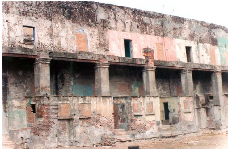
Figura 62.- Fachada de la crujía norte en donde se aprecian las alteraciones de la planta baja (1992)
