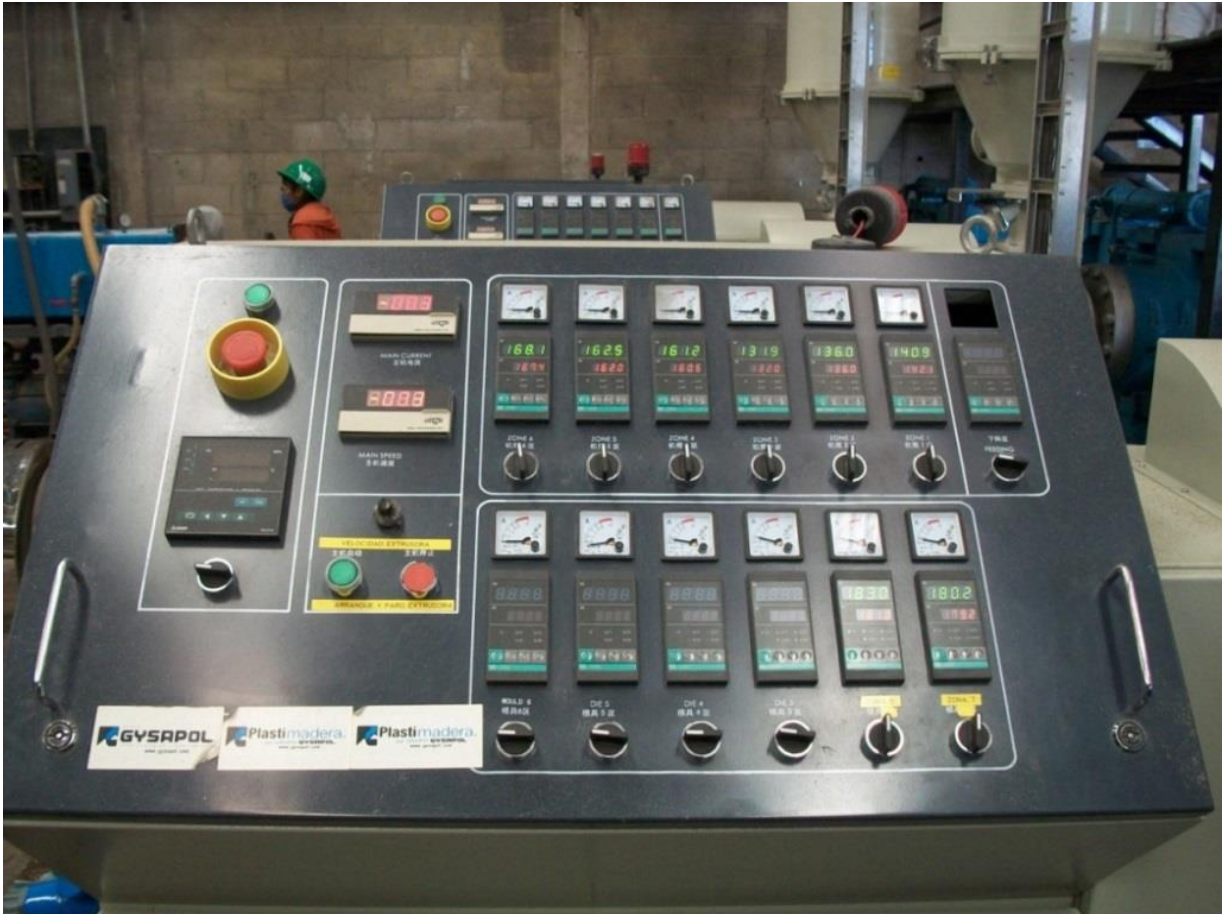
Imagen 4.11 Panel de control.
