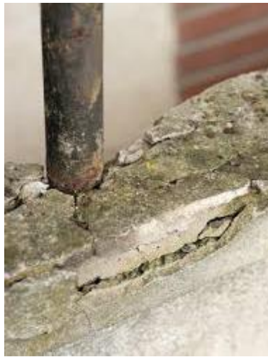
I.2. Agrietamiento de concreto por expansión de acero.
