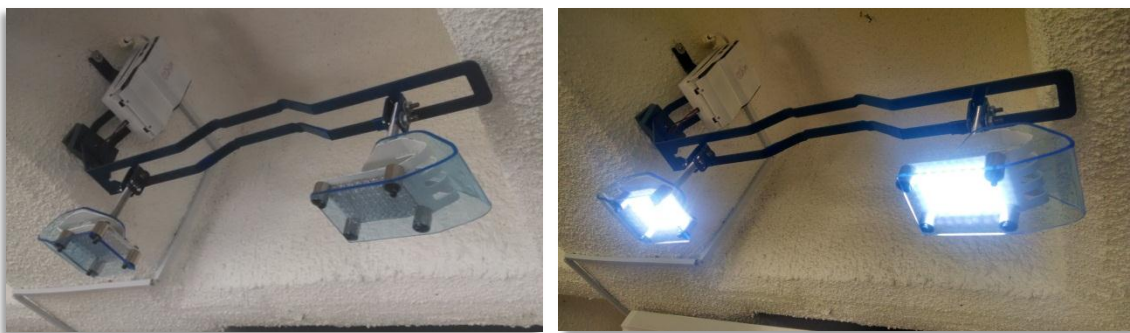
Figura 6.1 Lámpara instalada en un espacio de la losa del laboratorio de automatización, mostrando ambos estados (On/Off)
