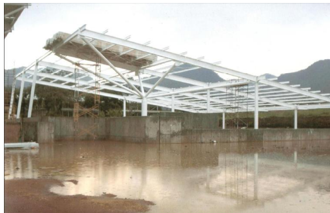
Figura 2.4.3 Cimientos de la Biblioteca con inundación en el interior de la estructura (Francisco Arredondo, Universidad Veracruzana).
