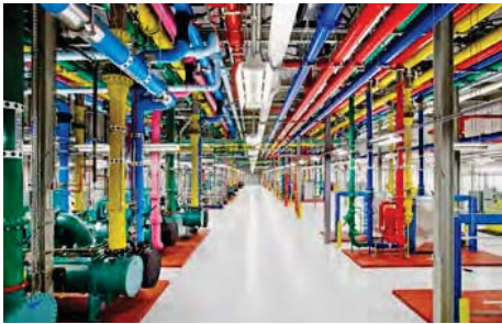
Cuarto de bombeo pasillo
