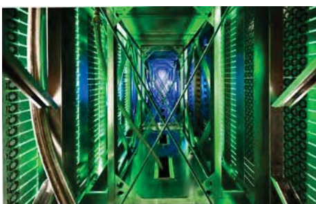
Interior ducto ventilación
