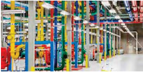
Cuarto de bombeo pasillo
