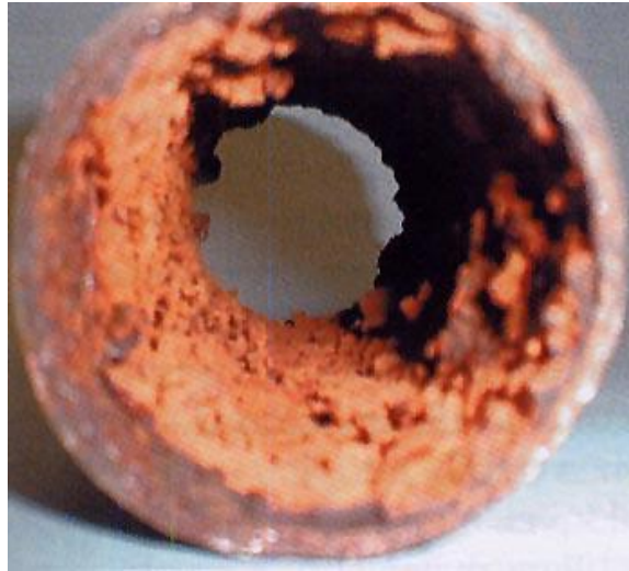
Figura 2.2 Corrosión en tuberías. Fuente: Teleingeniero, 2013. 14
