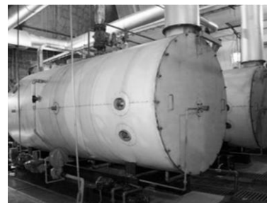
Cuarto de máquinas
