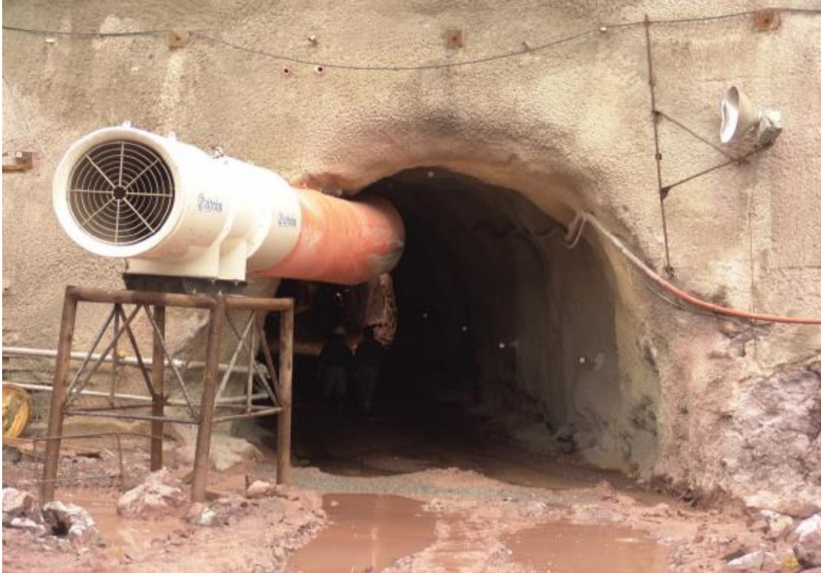
Fig. No. 103 Equipo de ventilación en la Galería
