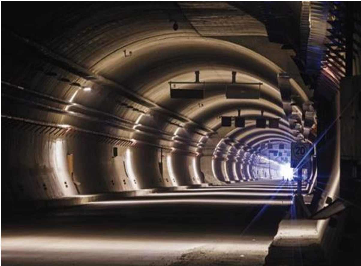
Fig. No. 12 Iluminación y señalización del Túnel Sinaloense
