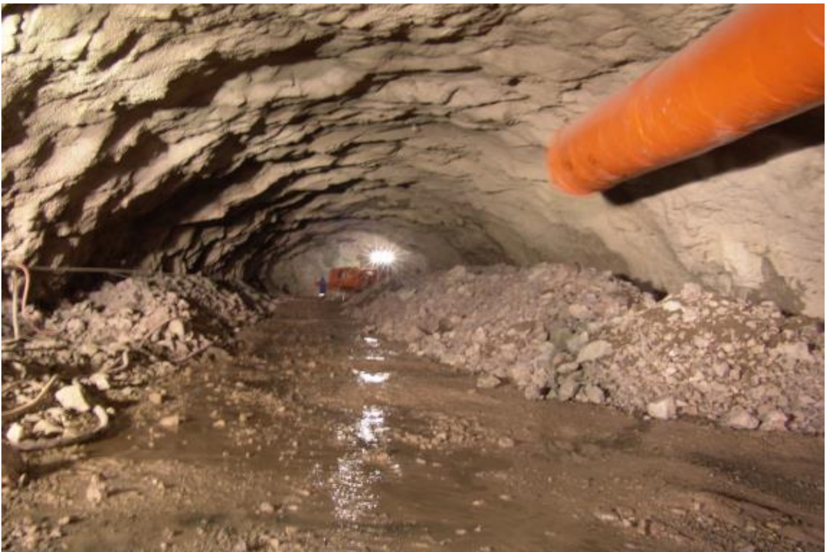
(Fig. No. 102) Tubería de ventilación en el frente de excavación
