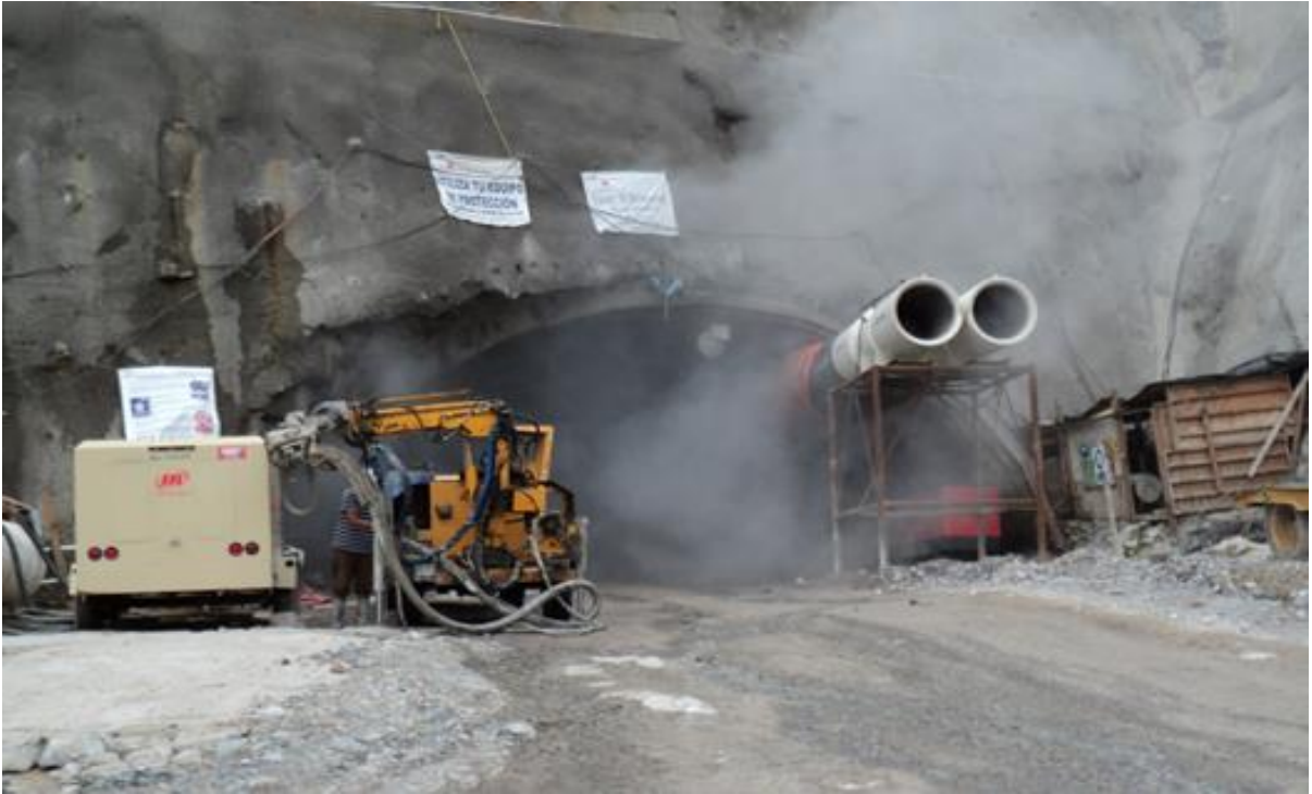
Fig. No. 101 Equipo de ventilación en el Túnel
