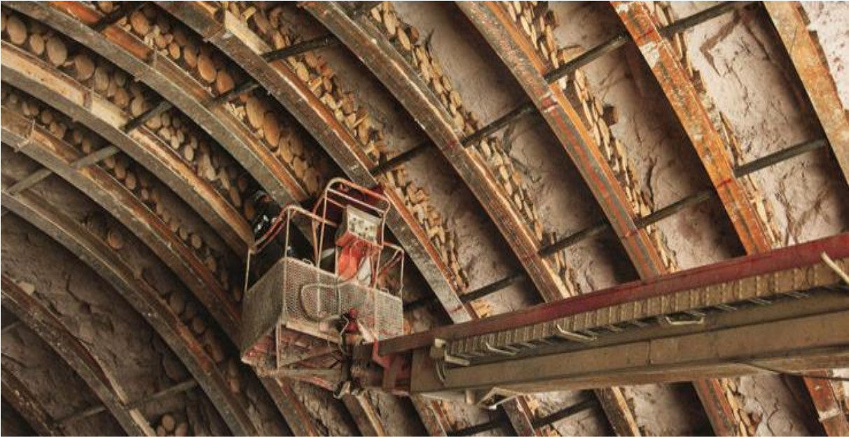
Fig. no. 117 Retaque de madera entre el marco metálico y recubrimiento de concreto.
