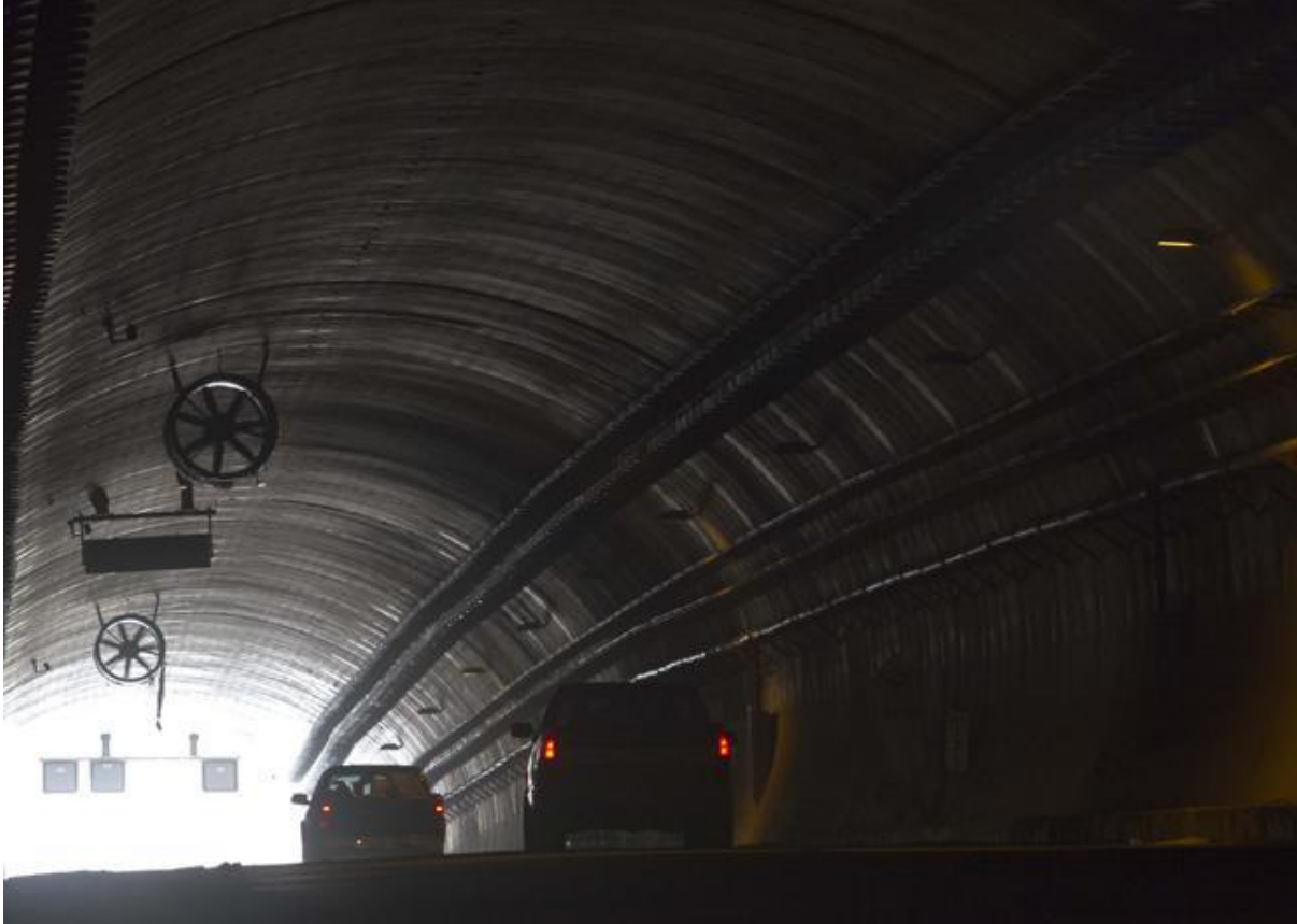
Fig. No. 13 Equipo de ventilación del Túnel Sinaloense
