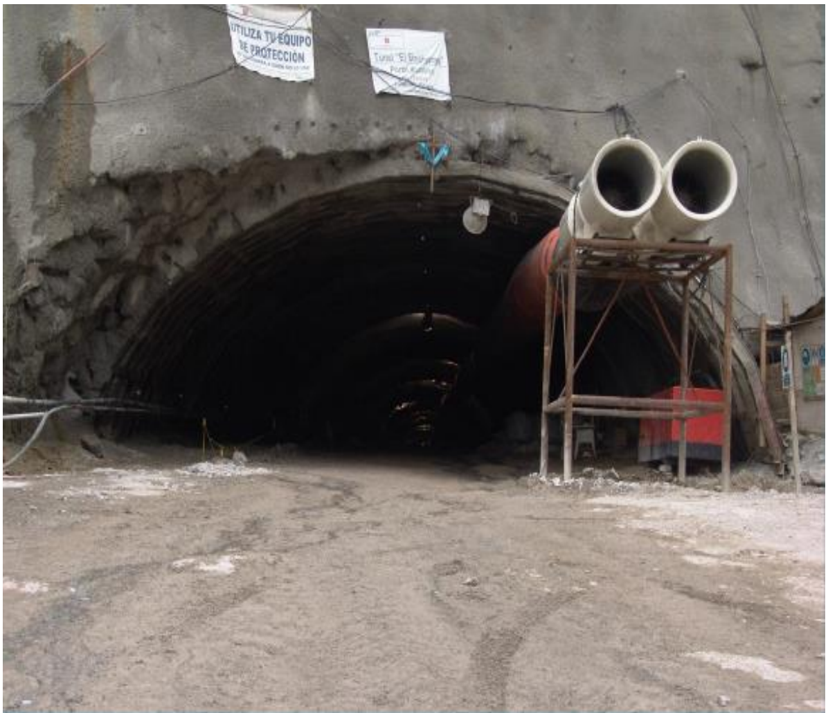
Fig. No. 100 Equipo de ventilación en el Túnel
