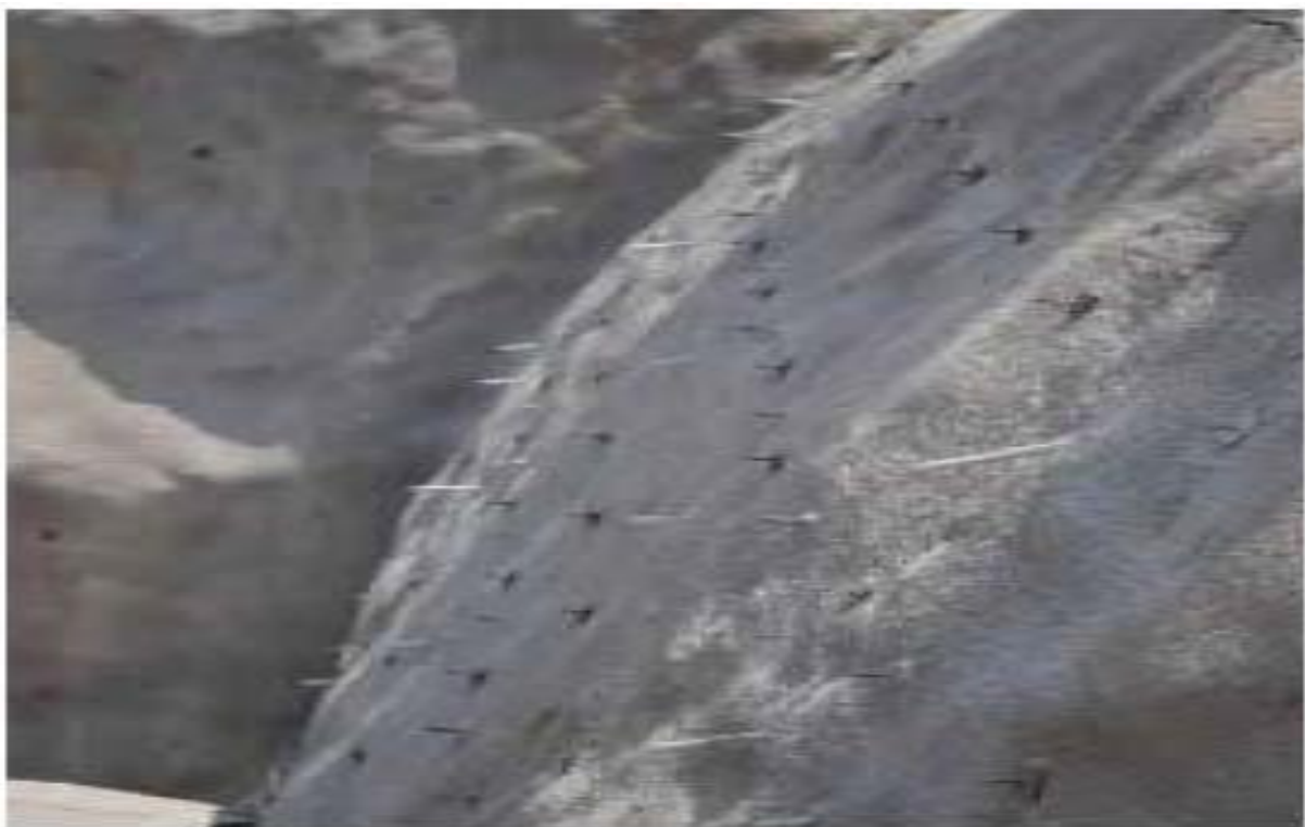
(Fig. No. 55) Drenes y anclas de fricción
