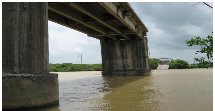
Figura 4.3 Diferentes vistas del puente Tonalá colapsado
