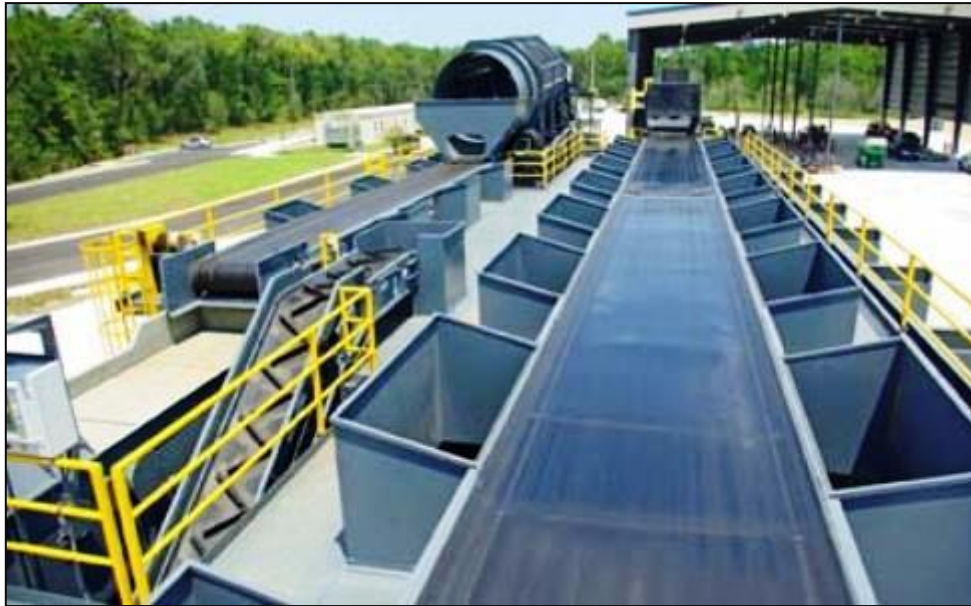
Figura 12. Imagen de la Planta Recicladora de RC&D en Jacksonville, Florida, EE.UU. ( www.cdrecycler.com )
