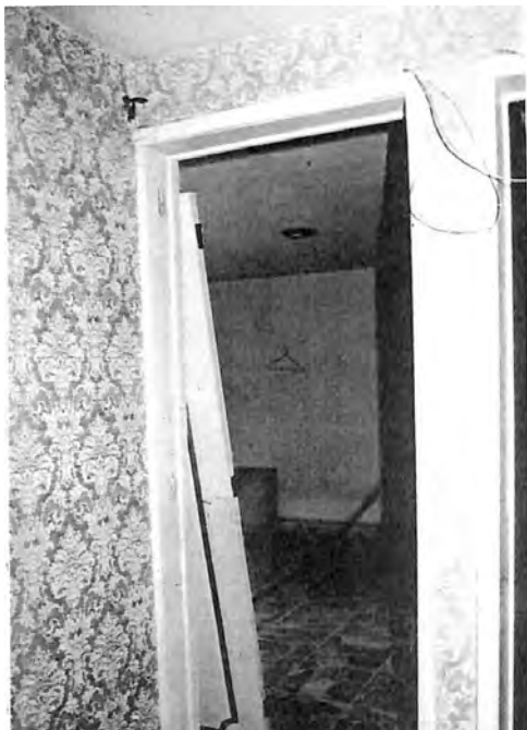
Figura 358. Entrada a una habitación donde se identifica una de las puertas desprendida en su origen
