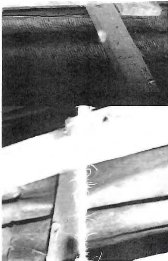
Figura 371. Imagen compuesta, se aprecia la viga y el elemento constrictor
